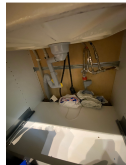
Rørøpplagg under kjøkkenbenk
