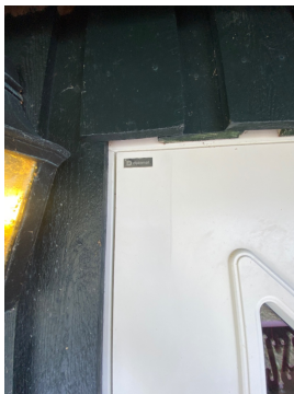
Manglende beslag samt åpninger mellom kledningsbord mot karm.
