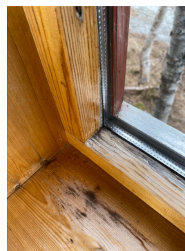
Tegn til mangelfull ventilering.
