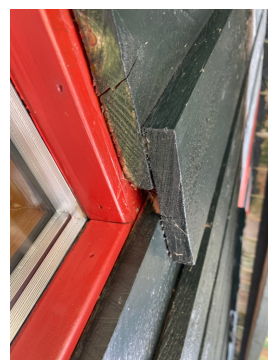
Åpninger mellom karm og kledning, manglende vannbrett/beslag.
