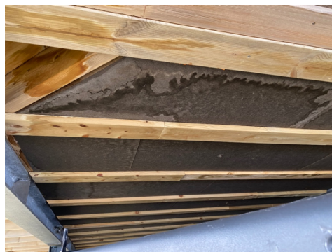
Fuktskjolder i stubbloft mot sørøst.
