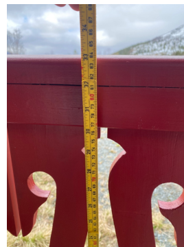
Høyde rekkverk målt til ca. 83 cm.
