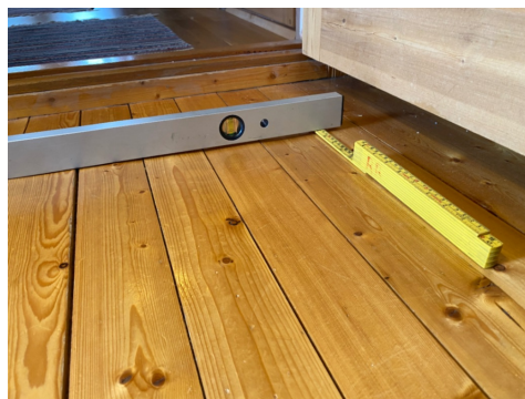
Skjevhet i gulvet på kjøkken.
