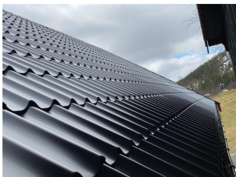
Det er påvist noe skjevheter i taket mot vest
