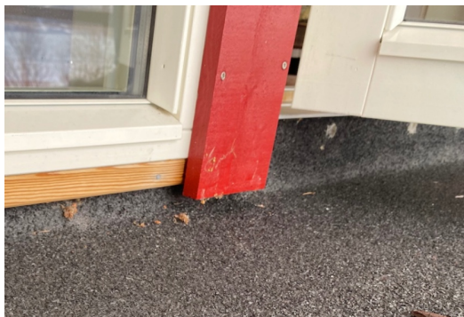
Balkongdør 2. etg. Manglende beslag i nedkant av døren
