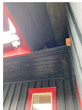
Åpninger i bør tettes for å forhindre skadedyr.
