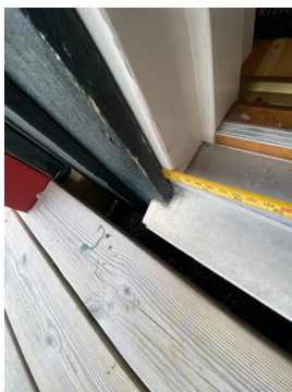
Glippe mellom dekkbord og karm.
