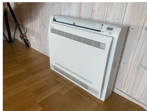
Varmepumpe innvendig del.
