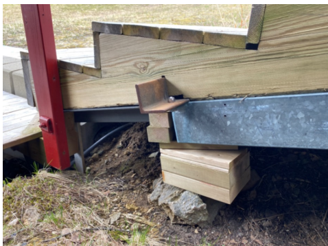
Fundamenteringen er stedvis understøttet av klosser.
