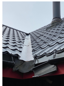
Det er registrert rust i kilrenne. Skade i takrenne.
