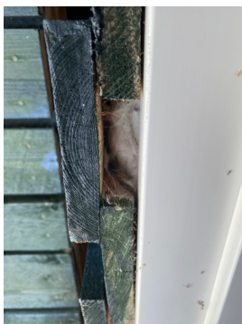
Åpning mellom bordkledning og karm.
