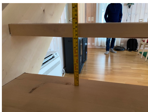
Åpning mellom trinn.
