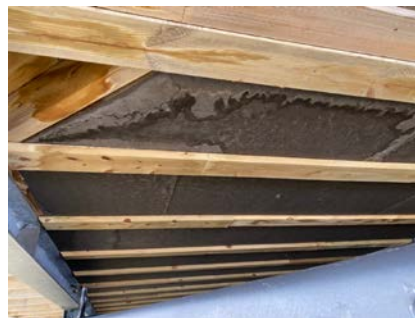
Fuktskjolder i stubbloft mot sørøst.
