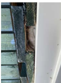
Åpning mellom bordkledning og karm.
