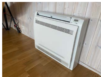
Varmepumpe innvendig del.
