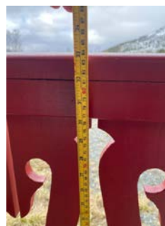
Høyde rekkverk målt til ca. 83 cm.
