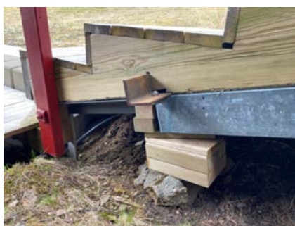
Fundamenteringen er stedvis understøttet av klosser.
