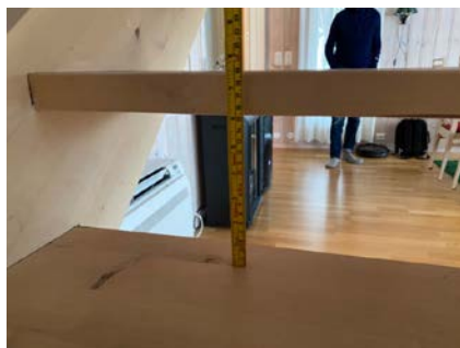
Åpning mellom trinn.
