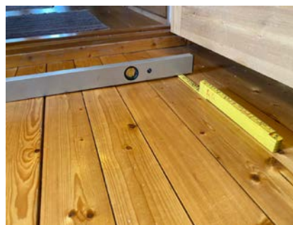
Skjevhet i gulvet på kjøkken.
