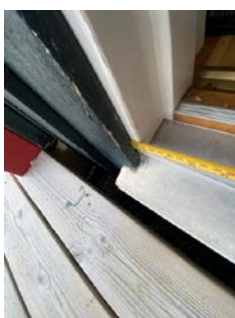
Glippe mellom dekkbord og karm.
