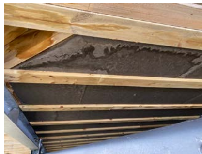
Fuktskjolder i stubbloft mot sørøst.
