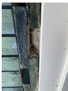
Åpning mellom bordkledning og karm.
