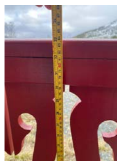
Høyde rekkverk målt til ca. 83 cm.
