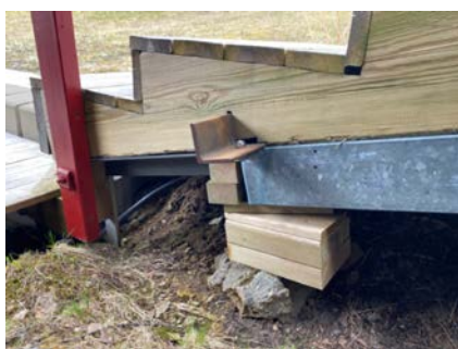
Fundamenteringen er stedvis understøttet av klosser.
