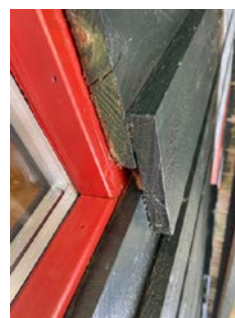
Åpninger mellom karm og kledning, manglende vannbrett/beslag.
