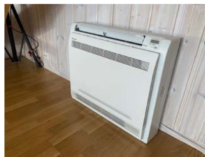
Varmepumpe innvendig del.
