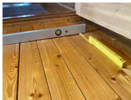
Skjevhet i gulvet på kjøkken.
