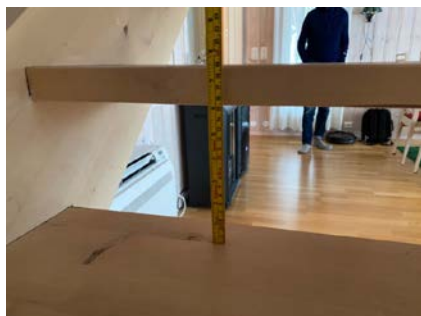
Åpning mellom trinn.
