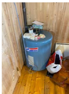
Forventet levetid for varmtvannstanker er 20-30 år
