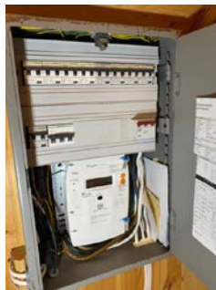
Sikringsskap med automatsikringer, plassert i gangen i loftsetasjen
