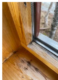
Tegn til mangelfull ventilering.
