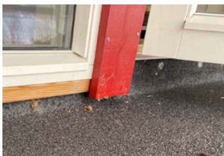
Balkongdør 2. etg. Manglende beslag i nedkant av døren
