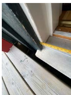
Glippe mellom dekkbord og karm.
