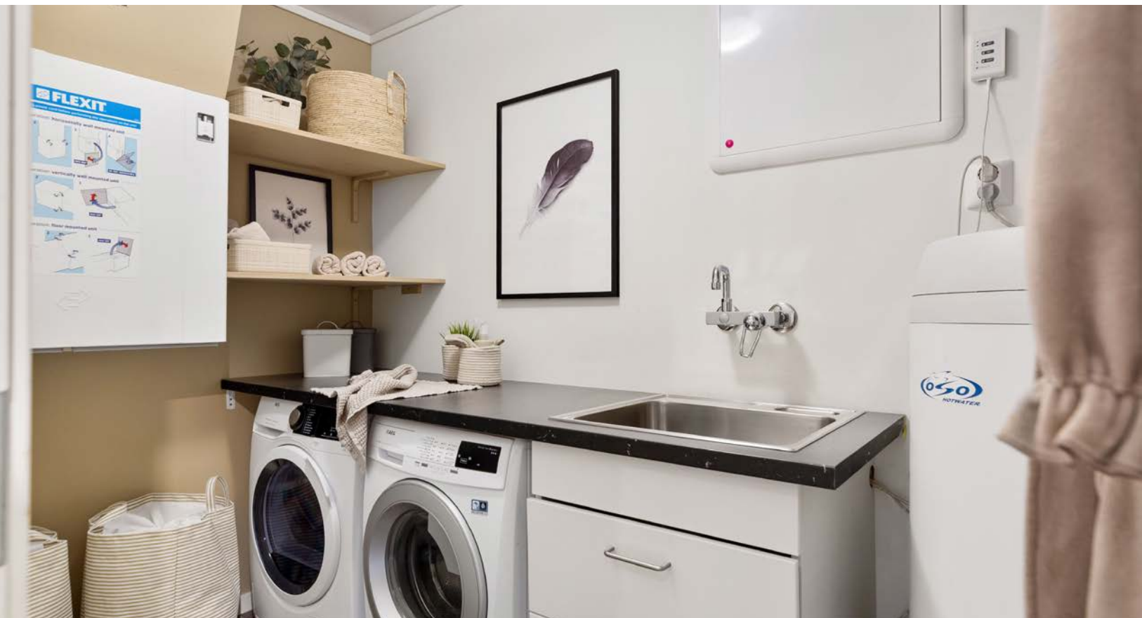
Vaskerommet ved siden av er på 4,5 m 2 og har praktiske løsninger for både oppbevaring og tekniske installasjoner.
