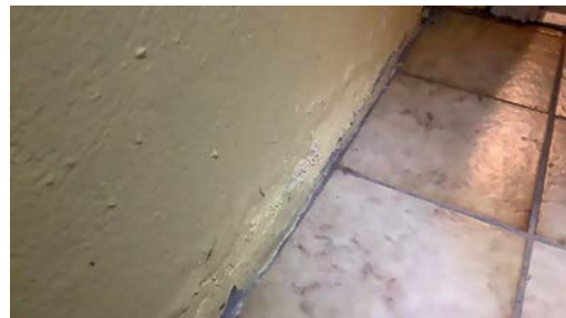
Saltutslag på betongvegg.
