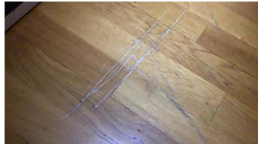
Skader i parkett.
