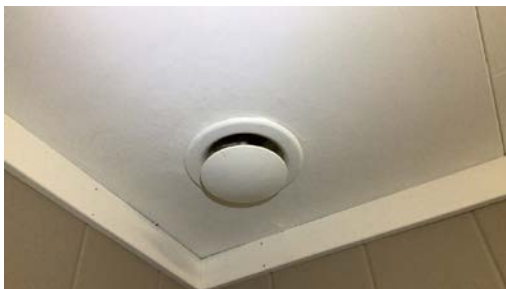
Noe svelling i himling rundt avtrekksventil.
