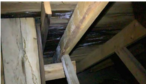
Lekkasje rundt luftehatt med fuktskader på loft.
