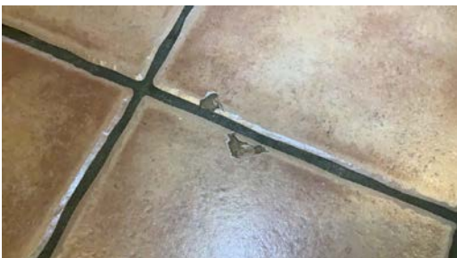
Skader i gulvfliser.
