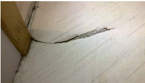
Sprukket gulvbelegg grunnet saltutslag.
