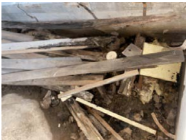
Råteskadet treverk på grunnen i krypkjeller.
