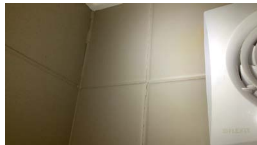
Riss i flisfuge inntil baderomsvifte.
