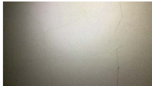
Riss i pipe.
