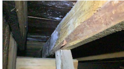
Muggdannelse på takstol og våt taktro.
