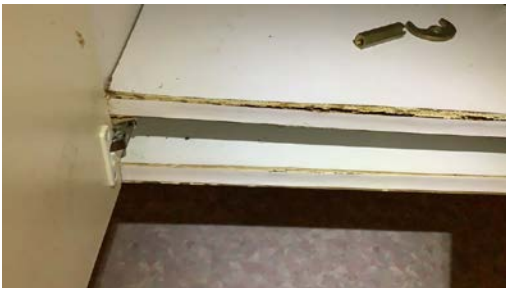
Svellskadet hylleplate og bunnplate.
