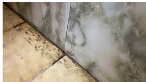
Løsnet overflate på baderomsplate.
