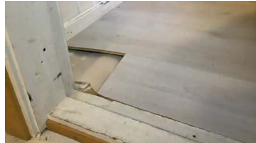
Laminatgulv buler og ett gulvbord mangler.
