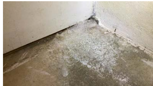
Saltutslag på betonggulv.
