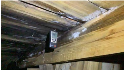
Taktro og takstol er våt med soppdannelse.
