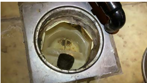
Plastsluk, uten synlig tettesjikt.
