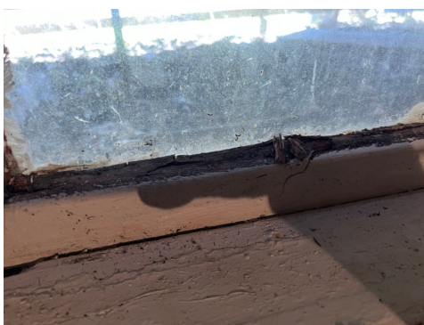
Råteskader i kjellervinduer.
