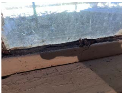
Råteskader i kjellervinduer.
