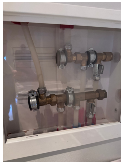
Fordelerskapet til rør-i-rør-systemet til badet. Her finnes stoppekraner til badet.
