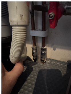
Vannrør og stoppekraner til kjøkkenet.
