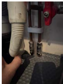
Vannrør og stoppekraner til kjøkkenet.
