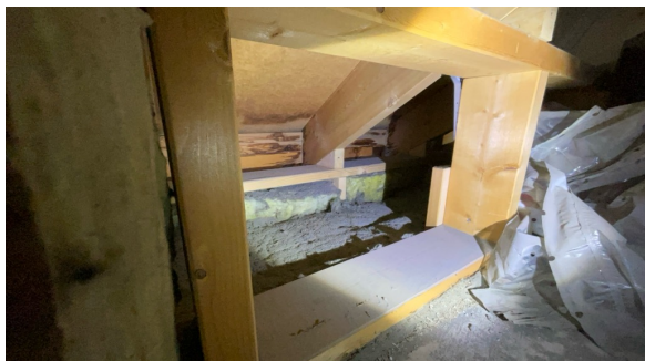
Fuktmerker ute raft, dette er sett via leiligheten H0303.
