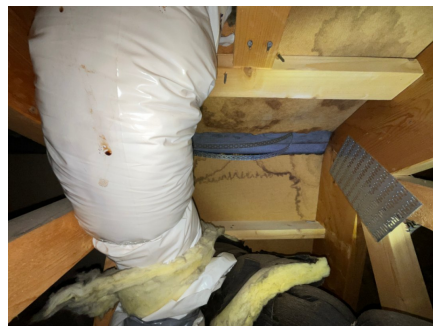
Fuktmerker i konstruksjonen oppe på kaldloft
