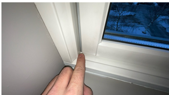
Pakning tetter ikke mellom karm og vindu.
