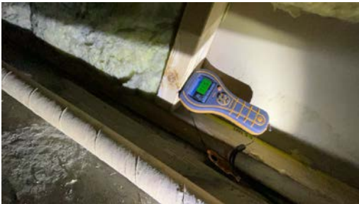
Fuktkontroll innside rekkverk i kaldloft, målt 11,5% vektprosent i trevirket.
