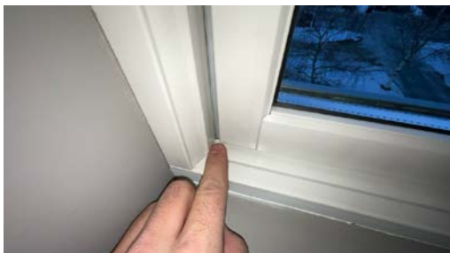
Pakning tetter ikke mellom karm og vindu.
