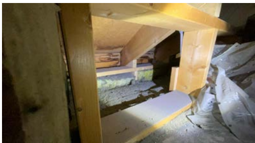
Fuktmerker ute raft, dette er sett via leiligheten H0303.
