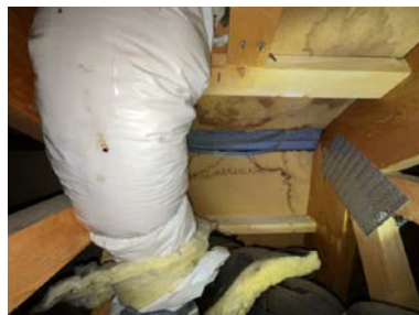
Fuktmerker i konstruksjonen oppe på kaldloft
