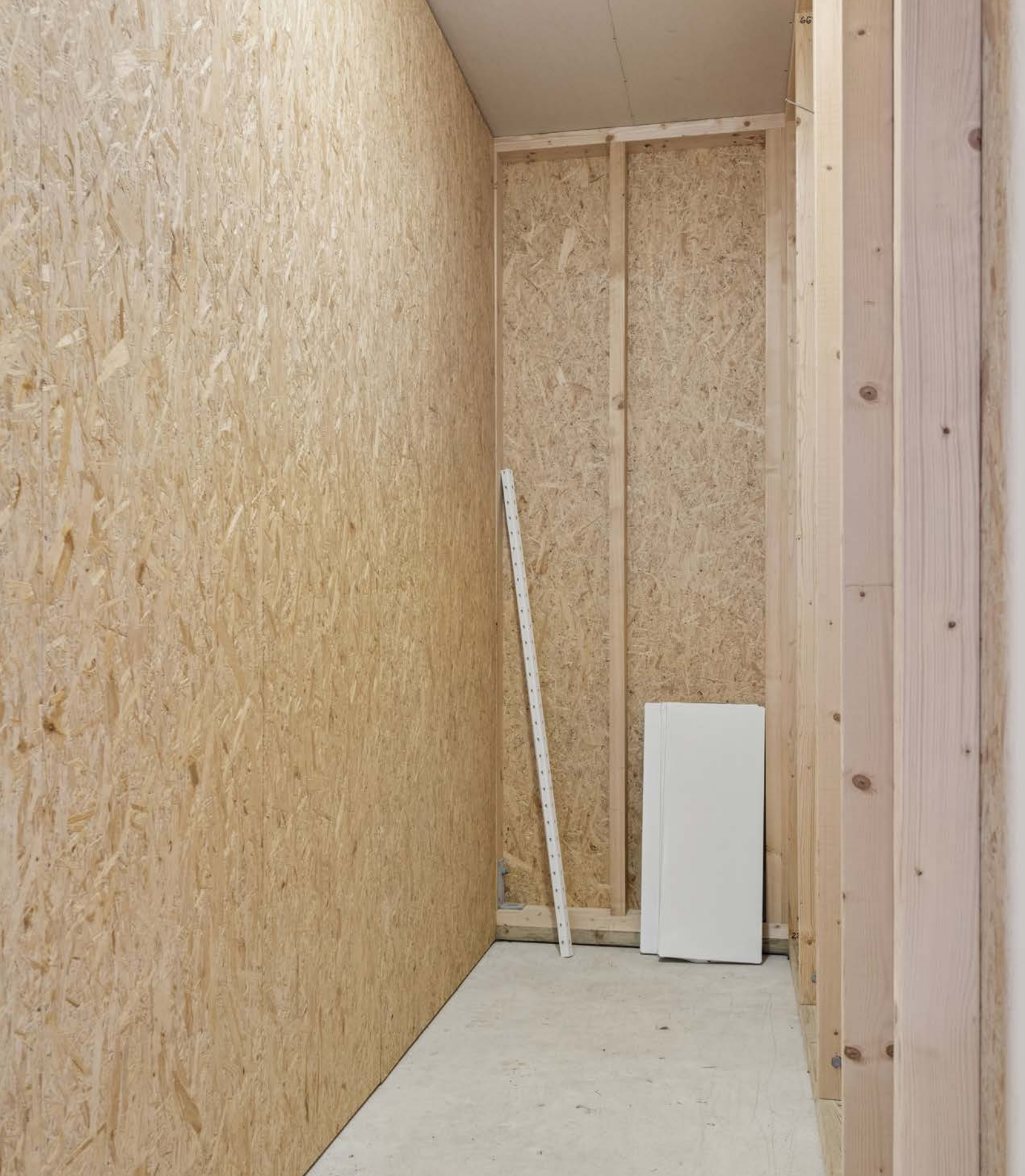
Sportsboden har vegger av OSB-plater og betonggulv gir et robust rom for lagring.
