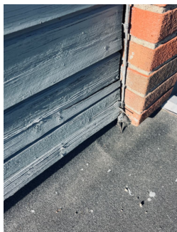
Skade på ytterkledning over inngangsparti.
