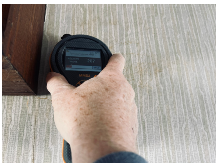
Forhøyede fuktverdier registrert.
