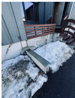
Riss/sprekker i forstøtningsmur.
