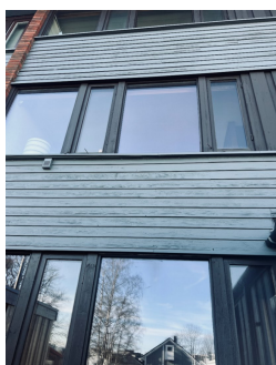
Bruks/værslittasje på ytterkledning.
