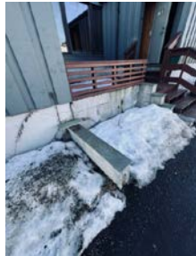
Riss/sprekker i forstøtningsmur.
