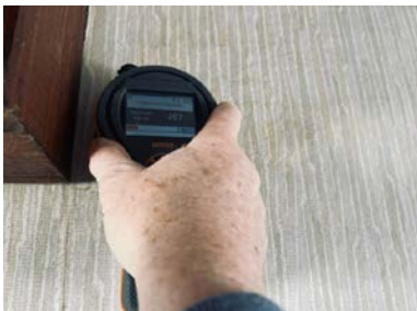
Forhøyede fuktverdier registrert.
