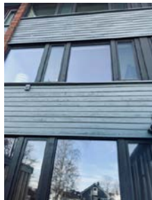
Bruks/værslittasje på ytterkledning.
