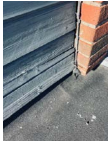
Skade på ytterkledning over inngangsparti.
