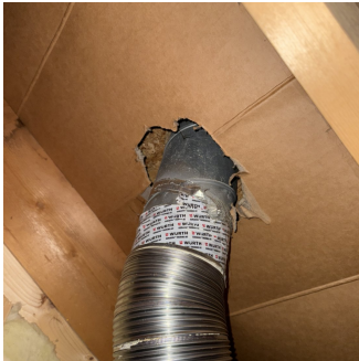
Manglende tekking rundt gjennomføring i undertaket
