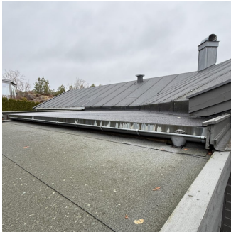
Overgang på tekking fra bod i mot eksisterende tak. Pannebord synlig under takrenne.
