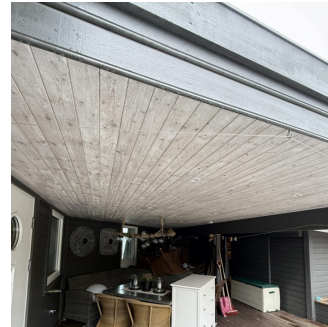
Panel i himling med svertesopp overflaten.
