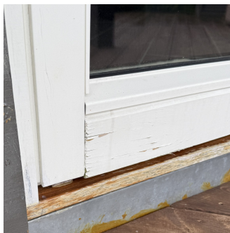
Oppsprekking av maling på dør
