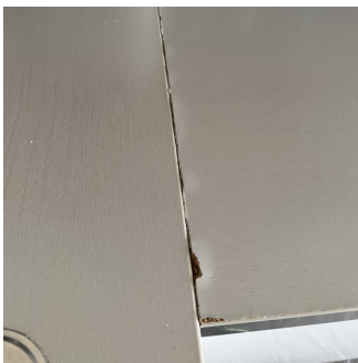
Svelling i skjot på benkeplate.
