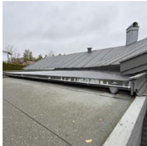
Overgang på tekking fra bod i mot eksisterende tak. Pannebord synlig under takrenne.
