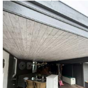
Panel i himling med svertesopp overflaten.
