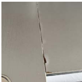
Svelling i skjøt på benkeplate.
