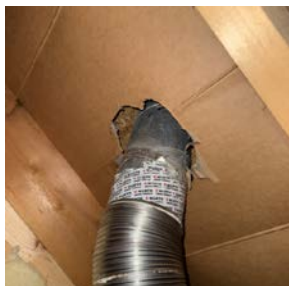
Manglende tekking rundt gjennomføring i undertaket
