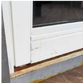
Oppsprekking av maling på dør
