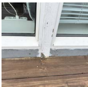
Manglende vedlikehold og belistning ned i mot terrassedekke
