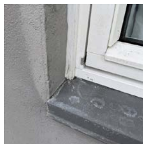
Ingen oppkant på beslag på sidene i mot puss.
