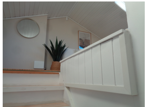
Mangler rekkverk ved trapp.
