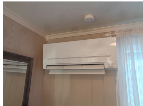
Varmepumpe i gang.
