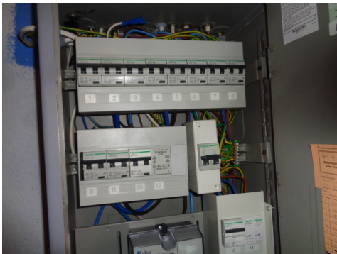
Sikringskap i trapperom.
