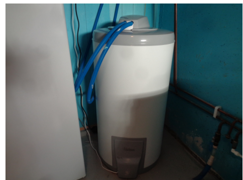
Varmtvannsbereder på vaskerom.
