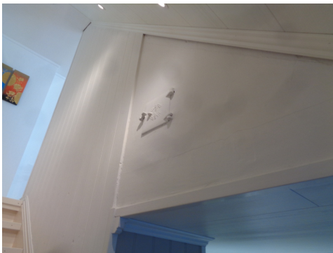
Ildfast plate mangler på gulvet under sotluke/feieluke på pipe.
