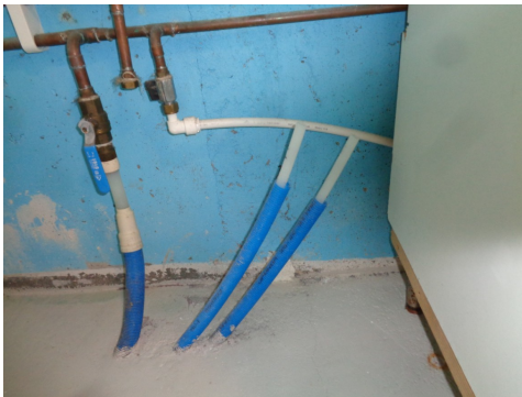
Rør i rør i betongdekke på vaskerom.
