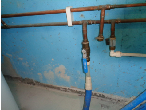
Stoppekran på vaskerom
