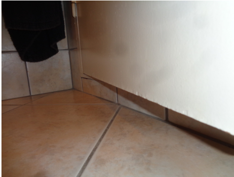
Skade på dørbld til bad.
