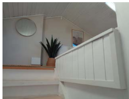
Mangler rekkverk ved trapp.
