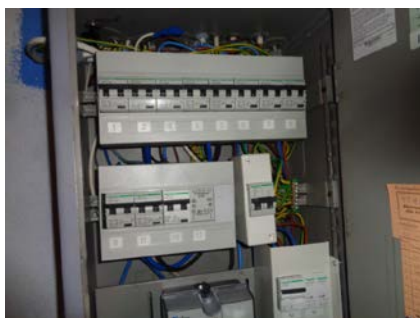
Sikringskap i trapperom.
