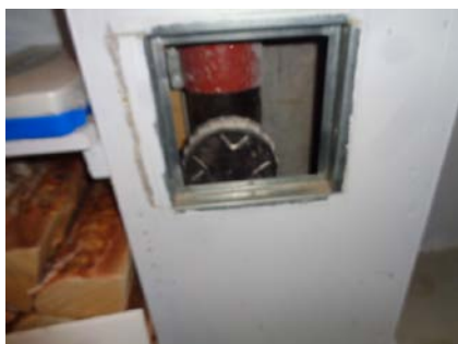
Stakeluke i kjellerrom.
