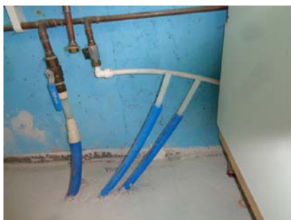
Rør i rør i betongdekke på vaskerom.
