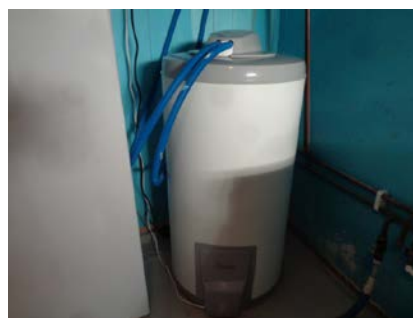
Varmtvannsbereider på vaskerom.
