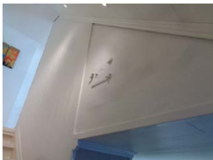
Ildfast plate mangler på gulvet under sotluke/feieluke på pipe.
