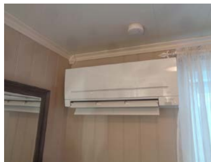
Varmepumpe i gang.
