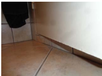
Skade på dørblad til bad.
