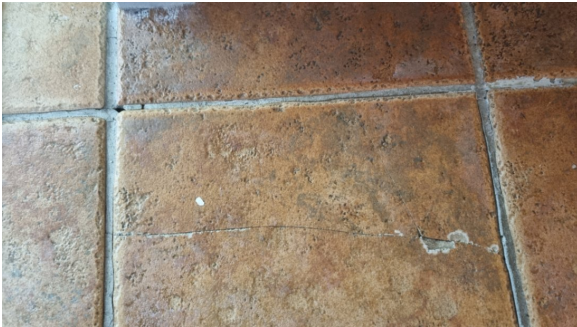
Sprekk i flis.
