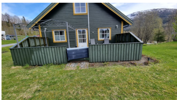
Markterrasse har noe værslitasje.
