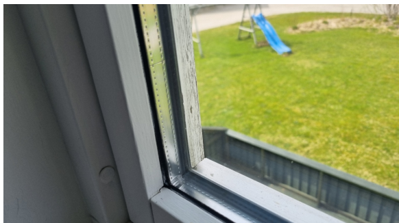
Vindu er værslitt.
