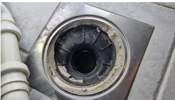
Det kan ikke konstateres synlig bruk av membran/tettesjikt på våtrommet.
