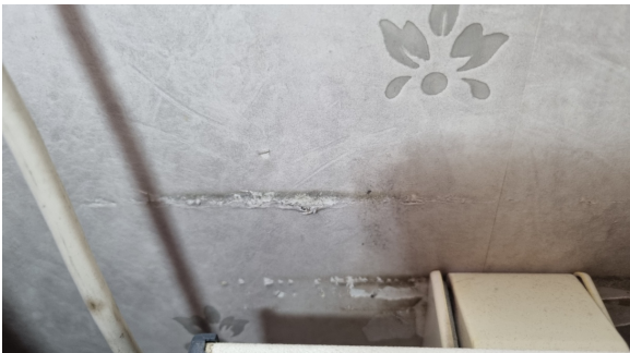
Overflateskade i tapet.
