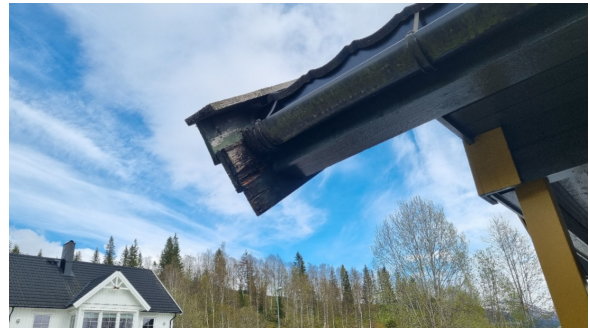
Råteskade i vindskibord.
