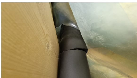
Utettheter rundt rørgjennomføring.
