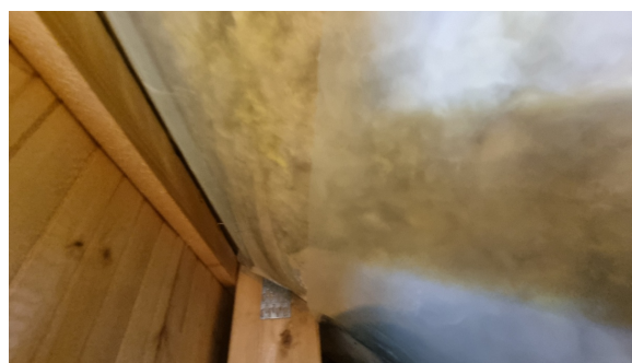
Skjøt er ikke klemt/tapet.
