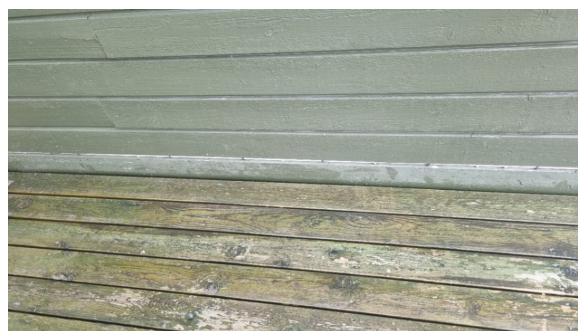
Det er ikke montert beslag i overgang mellom terrasse og yttervegg.
