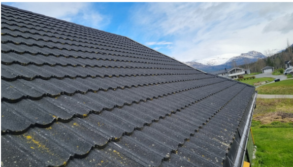
Det er ikke montert snøfangere.
