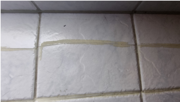
Sprekk i fliser.
