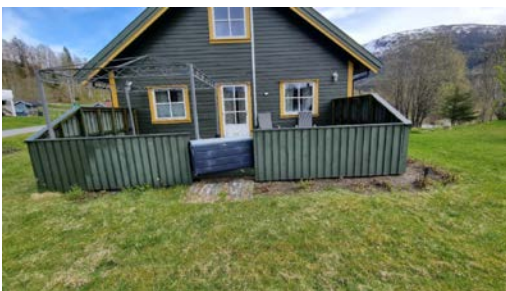
Markterrasse har noe værslitasje.
