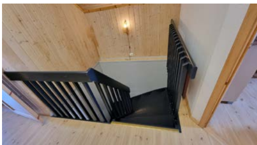
Det mangler håndløper på vegg i trappeløpet.
