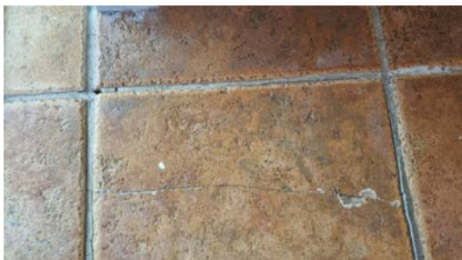
Sprekk i flis.
