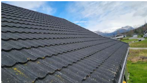
Det er ikke montert snøfangere.
