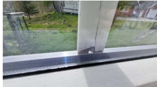
Sprosser har værslitasje.
