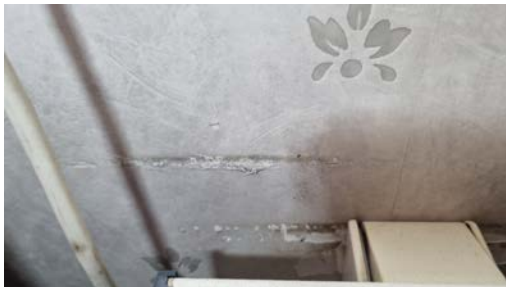
Overflateskade i tapet.
