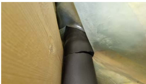
Utettheter rundt rørgjennomføring.
