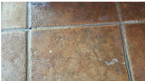
Sprekk i flis.
