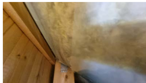
Skjøt er ikke klemt/tapet.
