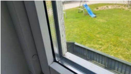
Vindu er værslitt.
