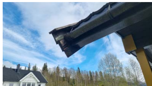
Råteskade i vindskibord.
