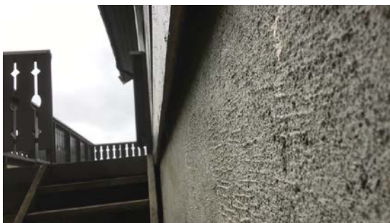
Mangler luftespalte bak kledning
