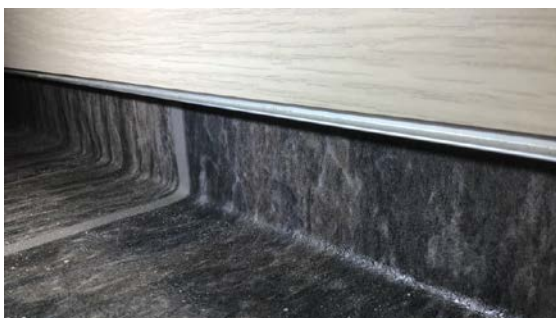
Våtromsplater mangler fuging i nedkant plater
