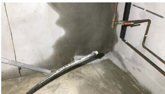
Fukt langs vegger og gulv
