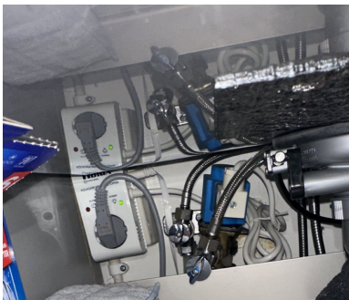
Røropplegg i kjøkkenbenk med Waterguard
