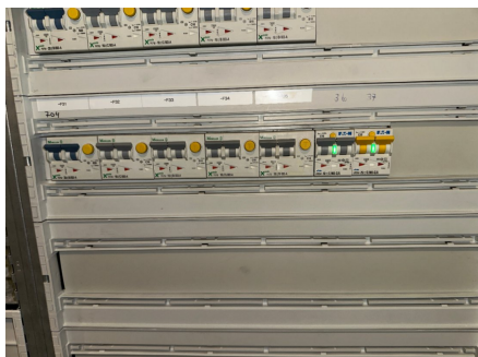
Sikringsskap med automatsikringer.
