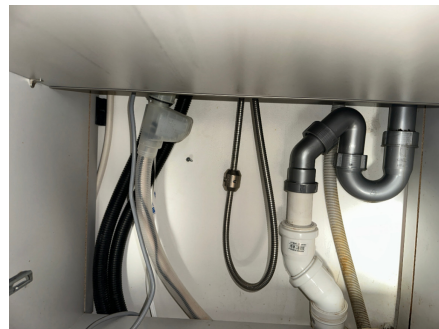
Røropplegg i kjøkkenbenk
