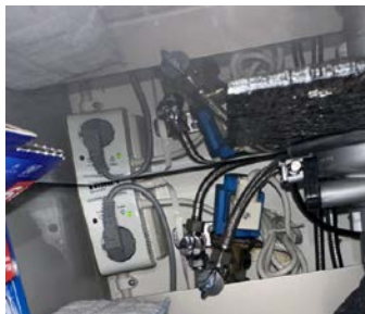
Røropplegg i kjøkkenbenk med Waterguard
