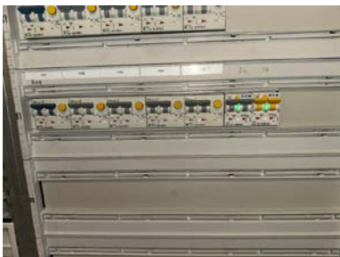
Sikringsskap med automatsikringer.
