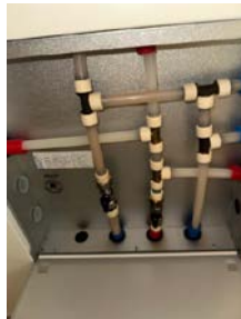
Samleskap med rørkurser og stoppekraner
