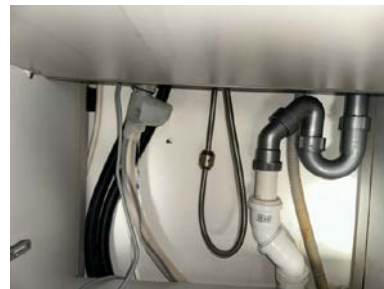
Røropplegg i kjøkkenbenk
