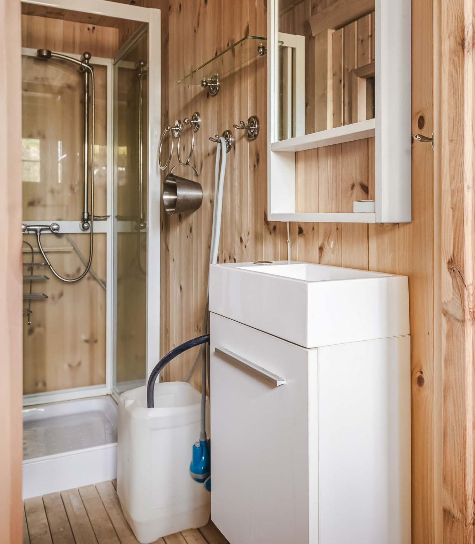
Hytta har et eget hygienerom med servantinnredning, speil og dusjkabinett. Pumpesystem for forbruksvann i dusj.
