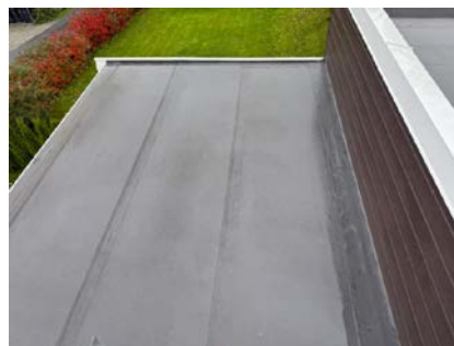
Tak over balkongen
