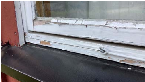
Eksempel på værslitt vindu.
