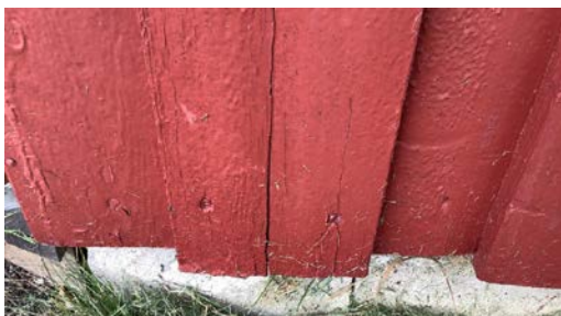
Eksempel på sprukket kledning.
