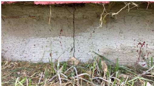
Eksempel på utvendig skråriss.
