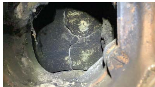
Sprekker i røykrør i pipe.
