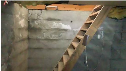
Kjellertrapp mangler rekkverk.
