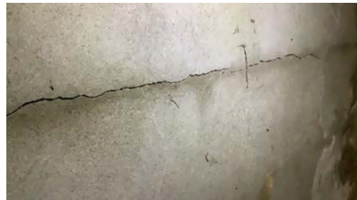
Eksempel på innvendig horisontalriss.
