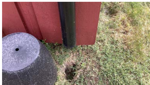
Mangelfull bortledning av takvann fra bolig.
