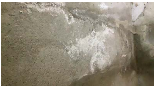
Saltutslag på grunnmur.
