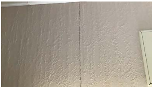
Eksempel på revnet tapet.
