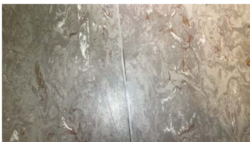
Glippe i sveiseskjøt i vinylbelegg.
