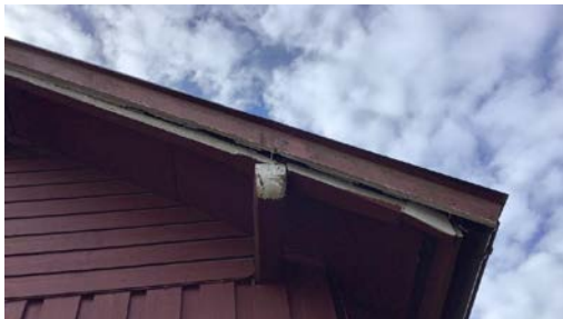
Råteskadet vindski og hengsperre.
