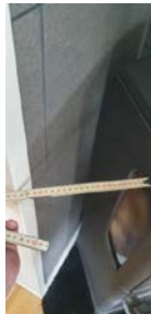
Avstand fra ildsted til brennbart materiale er for liten
