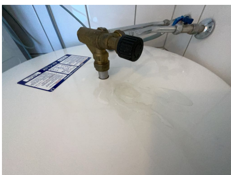
Synlig lekkasje fra varmtvannsbereider.
