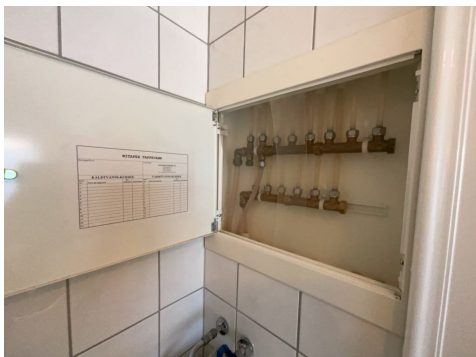
Skap til rør i rør system.
