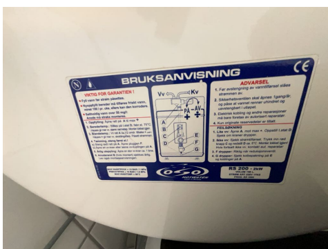
Spekk på varmtvannstank.
