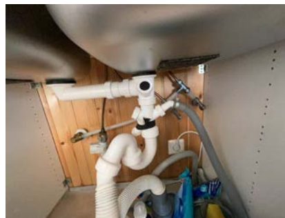
Del av rør til vann.
