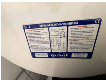
Spekk på varmtvannstank.
