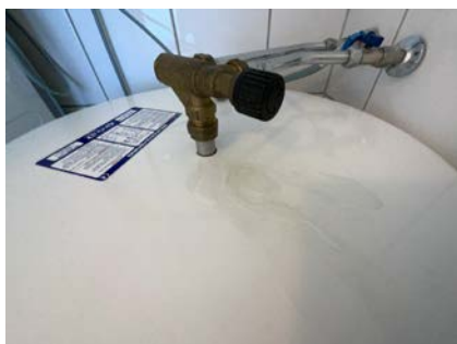
Synlig lekkasje fra varmtvannsbereider.
