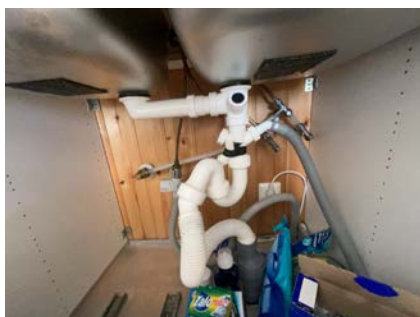
Del av rør til avløp.
