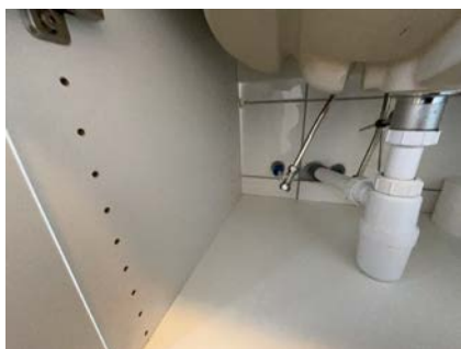
Del av rør til avløp.
