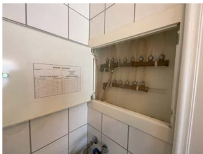
Skap til rør i rør system.
