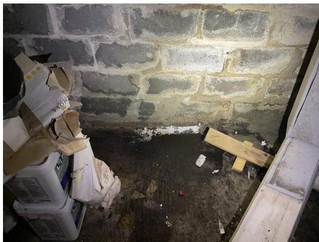
Visuell fuktig betonggulv i blind kjeller/krypkjeller
