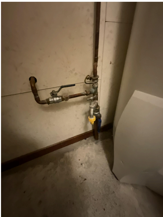
Stoppekrane på vaskeromm
