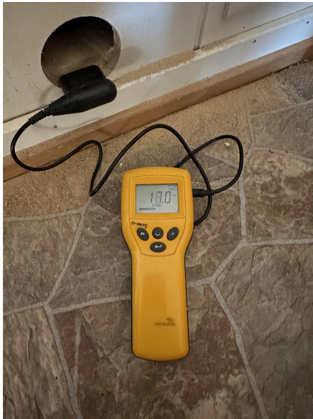
I svill kjellerstue/bad indikert fuktverdier på 18,0 % vekt
