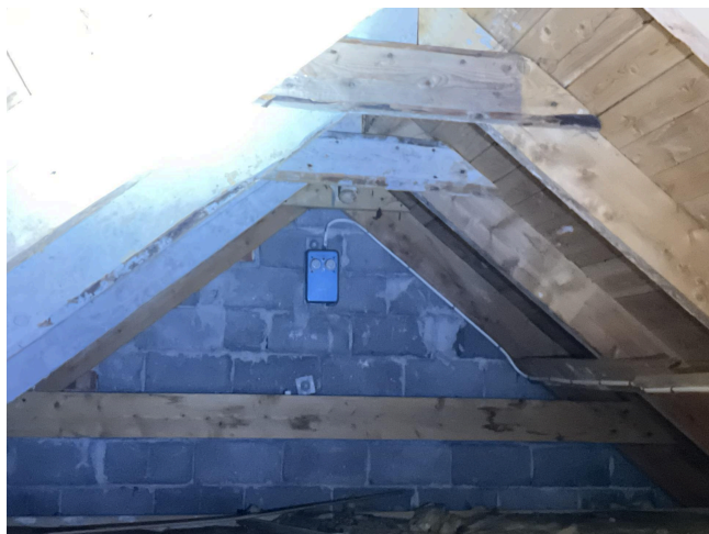
Hovedsikringen på kaldloft
