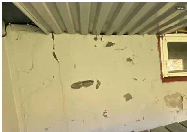
Registrert sprekker/avflassing på grunnmur under veranda
