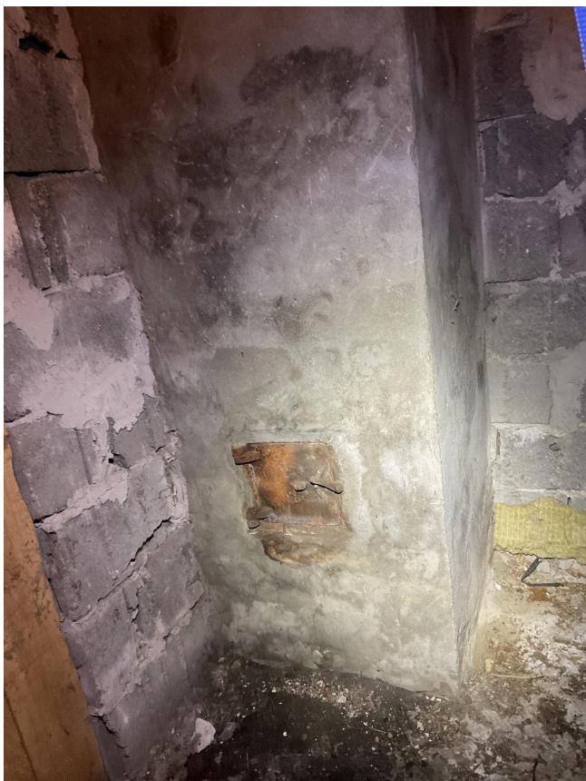
Pipe i krypkjeller
