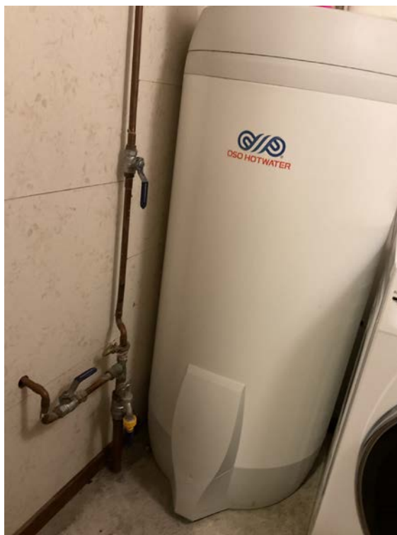
v.v.bereder på vaskerom
