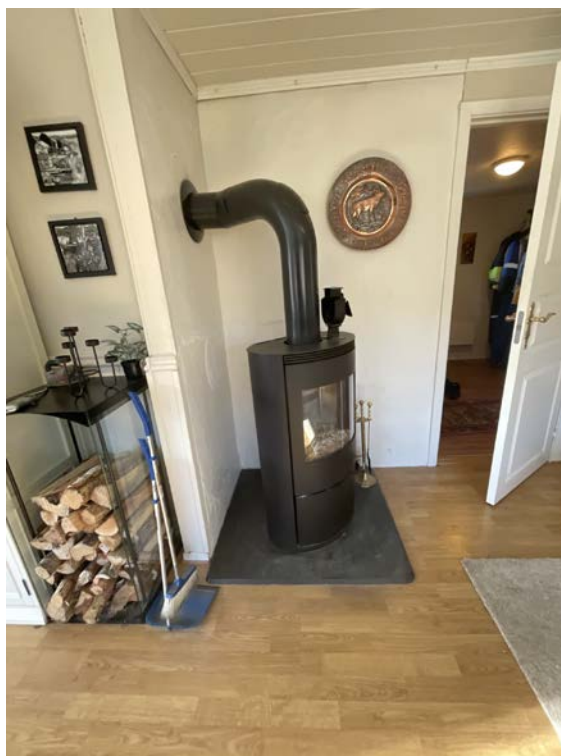
Fremspring på vedovn er litt under dagens krav
