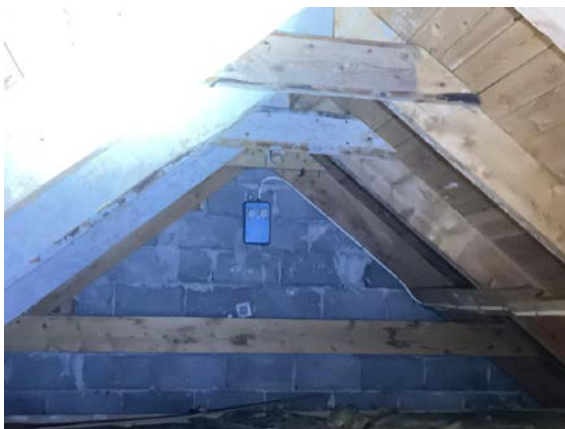
Hovedsikringen på kaldloft
