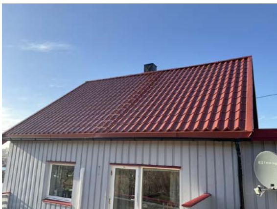
Hovedbygg er tekt profilerte metallplater. Mangler snøfangere iht dagens krav
