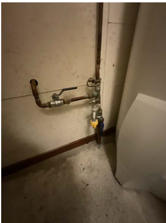
Stoppekrane på vaskeromm
