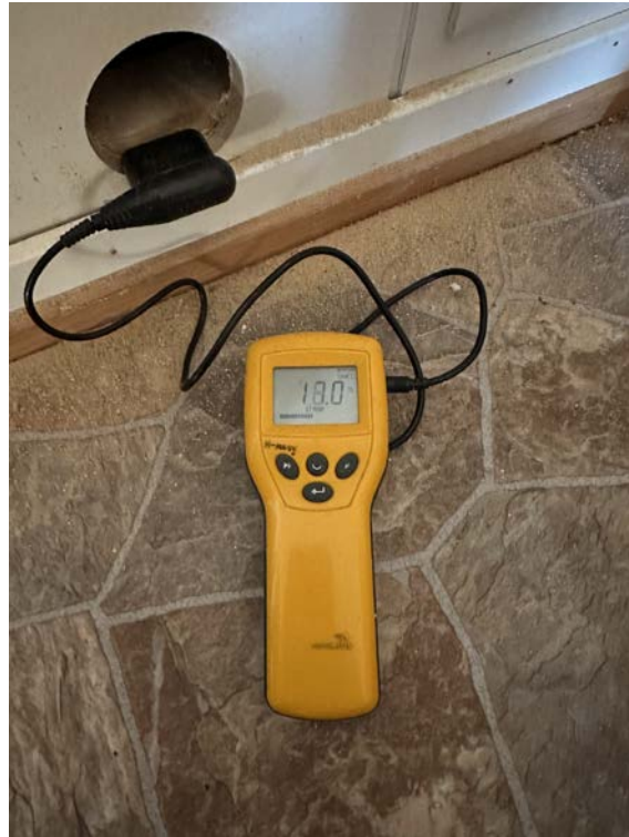
I svill kjellerstue/bad indikert fuktverdier på 18,0 % vekt
