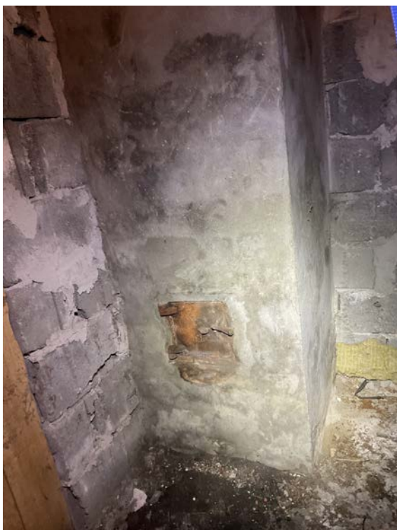
Pipe i krypkjeller
