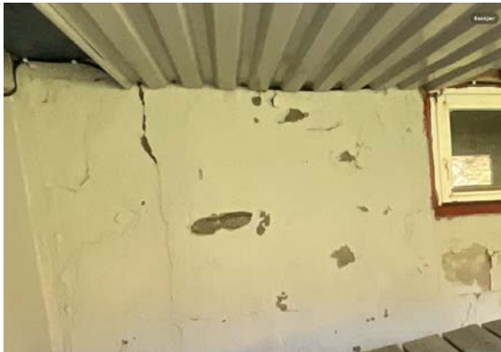
Registrert sprekker/avflassing på grunnmur under veranda
