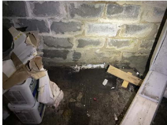
Visuell fuktig betonggulv i blind kjeller/krypkjeller
