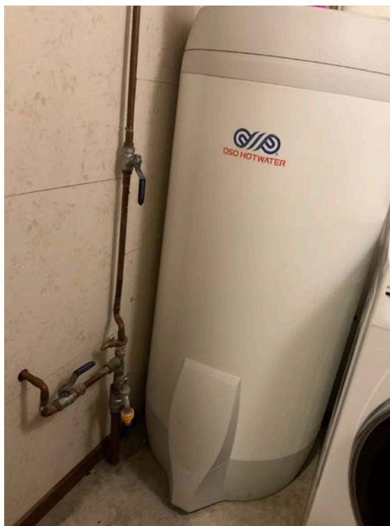
v.v.bereder på vaskerom
