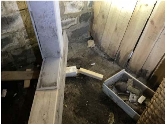
Nedre del av trevegg med synlige fuktpåkjenninger i blindkjeller/krypkjeller mot kjellervegg
