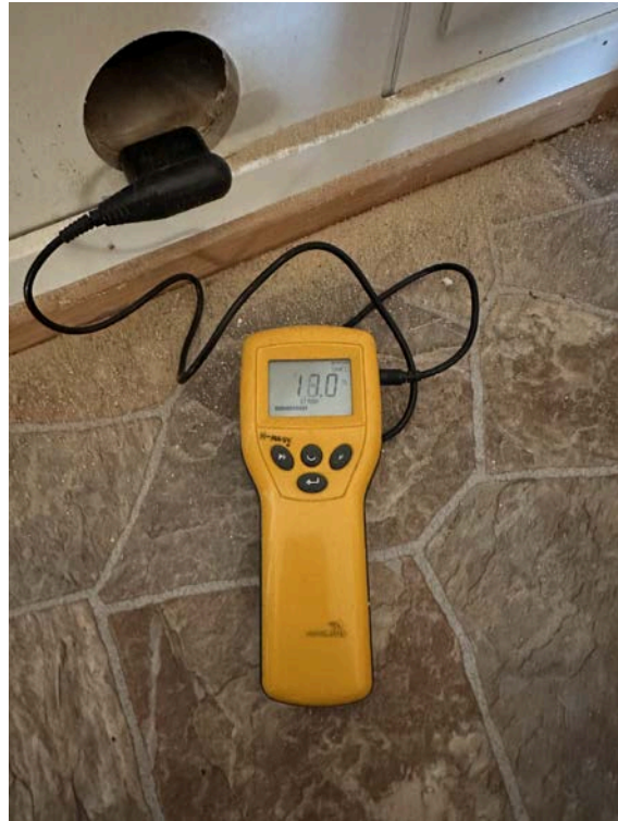
I svill kjellerstue/bad indikert fuktverdier på 18,0 % vekt
