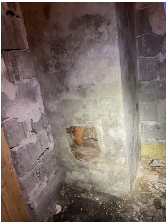
Pipe i krypkjeller
