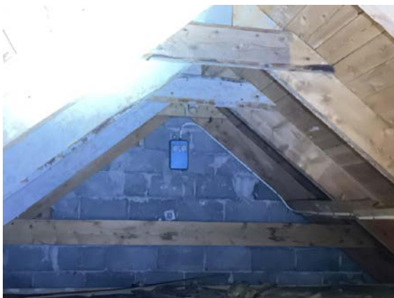
Hovedsikringen på kaldloft
