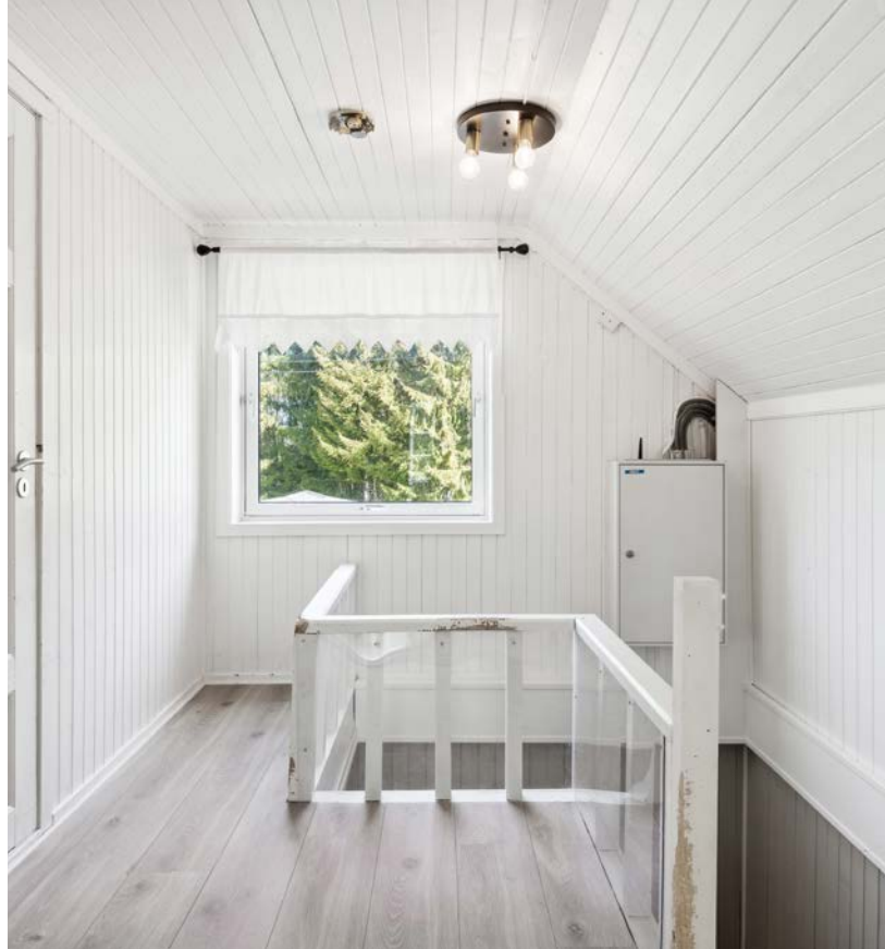
Loftsgang med sikringskap fra 2022. Mye ny el-installasjon på hovedplan.
