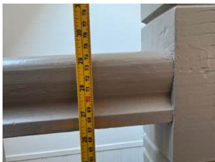
Rekkverkshøyde er under 0,90 m.
