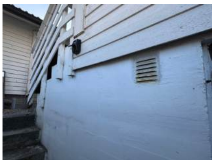
Konstruksjonsutforming når det er boligrom under utvendig trapp gir økt fare for skader. Nærmere undersøkelser og ev. utbedringer må påregnes.
