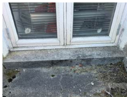
Ingen beslag eller skrående skifer under vinduer i u-etg. Det øker faren for fuktinntrenging.
