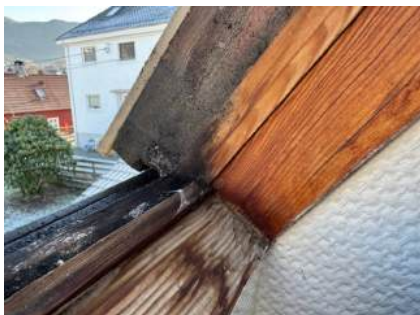
Fukt i karm på takvindu.
