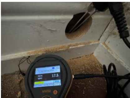
Måling av trefukt/vektprosent.
