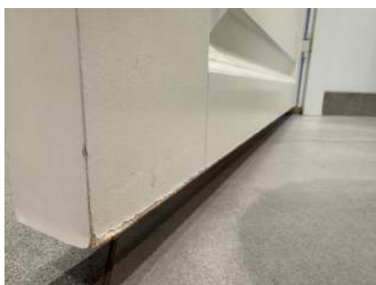
Fuktutsvelling/slitasje i nedre del av badedør i u-etg.
