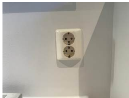
Vanlig stikkontakt i våtsone over servant.
