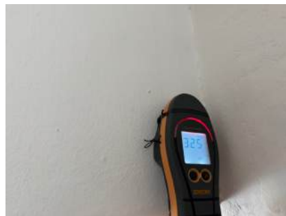
Forhøyede fuktverdier v/ pipe på det ene soverommet i loft-etg. Taktekking må undersøkes nærmere og utbedres.
