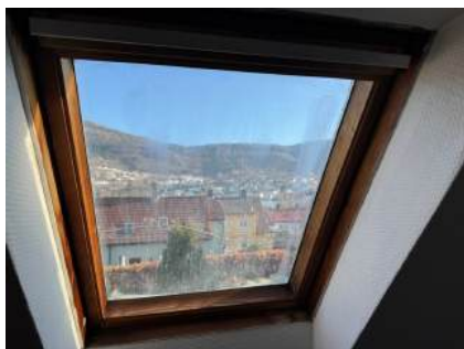
Sprekk og punktering i glass på takvindu.
