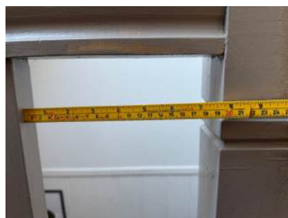
Åpninger i rekkverk er større enn 10 cm.
