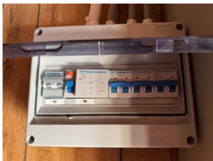
Sikringsskap i bod.
