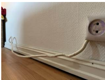
Løs ledning på det ene soverommet i loft-etg. Må utbedres.
