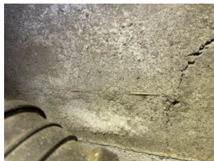
Saltutslag på innside av grunnmur. Det indikerer fuktvandring i grunnmuren.
