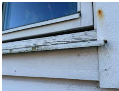
Malingsflass på utvendig karm.
