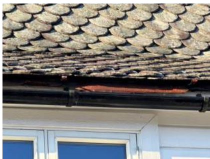
Rust på takbeslag.
