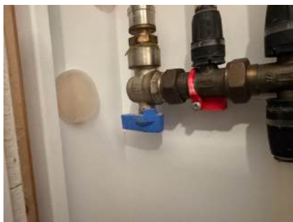
Stoppekran i rør i rør skap.
