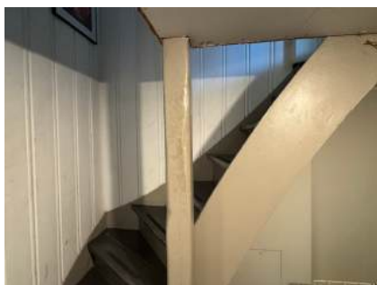
Det mangler skikkelig rekkverk v/ trapp til u-etg. Bør utbedres.
