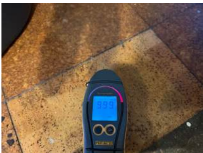
Forhøyede fuktverdier i betonggulv.
