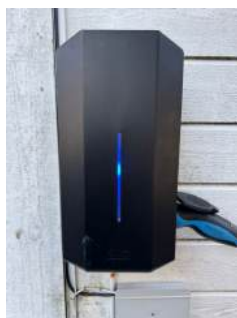
El. bil ladestasjon v/ biloppstillingsplass.
