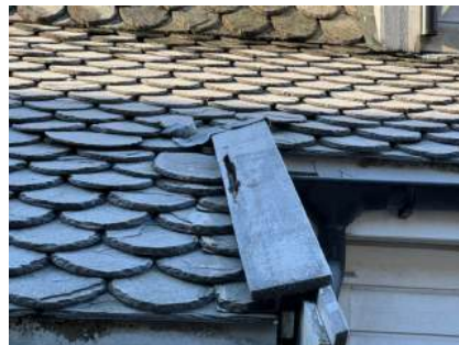
Råte i dekkbord.
