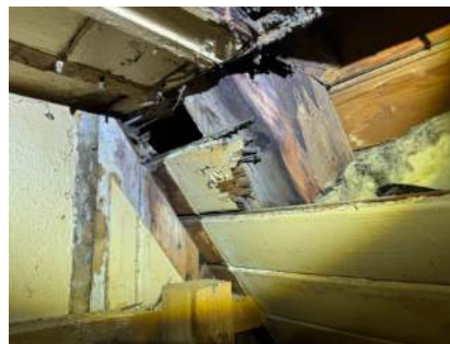
Fuktmerke og tørr råte i trevirke på koffertloft.
