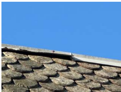
Rust på takbeslag.
