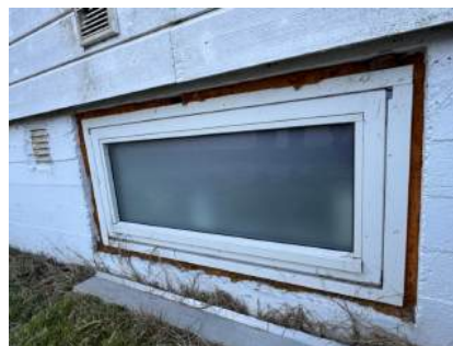
Uferdig tetting rundt badevinduer i u-etg.
