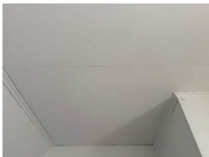
Riss/sprekk i plateskjøt på soverom i loft-etg.
