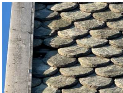
Manglende skiferstein ved vindskibord.
