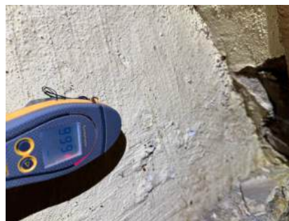
Forhøyede fuktverdier på pipe på koffertloft.
