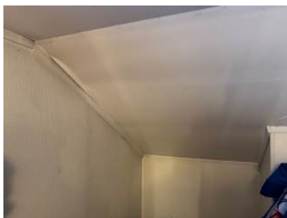
Misfarging og heksesot/støvkondens under utvendig trapp i u-etg.
