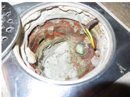
Sluk i dusj - støpejernssluk - ikke benyttet noen form for moderne tettemetoder.
