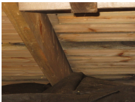
Det ses at isolasjonen ligger helt opp mot rupanel, uten noen form for etablert luftespalte. Det ses svertesopp.
