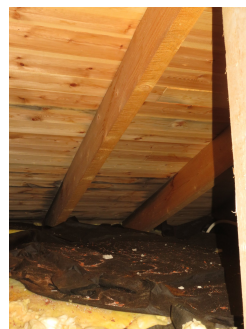
Påvist fuktproblematikk som følge av lekkasje (Antatt årsak), alternativt som følge av kondenseringer
