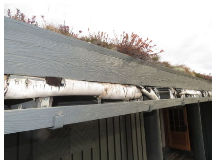
Bildet viser takrenneløsningen med stålkroker for trerenner festet direkte til sperrendene, samt at det ikke er noen beskyttende beslagløsninger.
