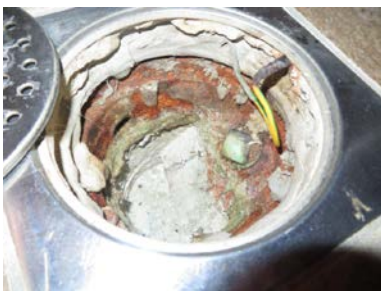
Sluk i dusj - støpejernssluk - ikke benyttet noen form for moderne tettemetoder.
