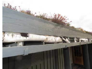
Bildet viser takrenneløsningen med stålkroker for trerenners festet direkte til sperrendene, samt at det ikke er noen beskyttende beslagløsninger.
