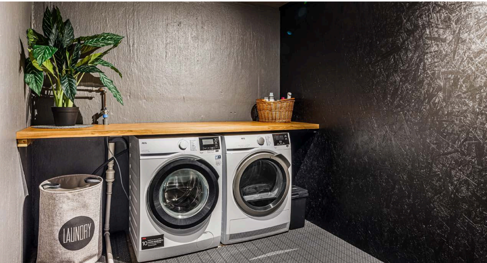
Praktisk vaskerom i kjelleren som ble malt og oppgradert med plastfliser på deler av gulvet i 2019. Praktisk med plass og opplegg for både vaskemaskin og tørketrommel under benkeplate.
