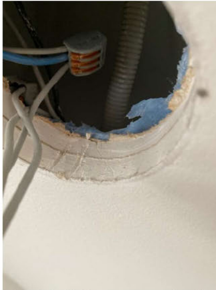
Bilde 19. Viser lampe mot loft, brudd på damspærre, ulovlig elektriske koblingspunkter i tak, gjelder et stort antall lamper i 2 etg mot kaldt loft, spesielt vinterstid. Avvik jfr FEL §§1,9,10,12,13,16,17,21,34,35,36 + Produktkontrollloven §3. Også brudd på Tilsynslovens §§2,10, og kvalifikasjonsforskrift og krav til hvem som har anledning til å utføre hva i norske elanlegg.
