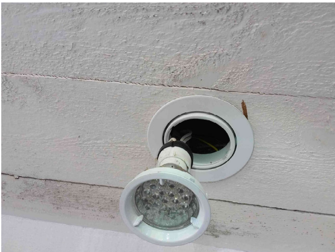
Skjema: "SpareBank1 Brannforebyggende elkontroll" Spørsmål: Merknad Beskrivelse: Downlights utvendig kjellerplan, Filnavn: IMG_20200528_095959.jpg
