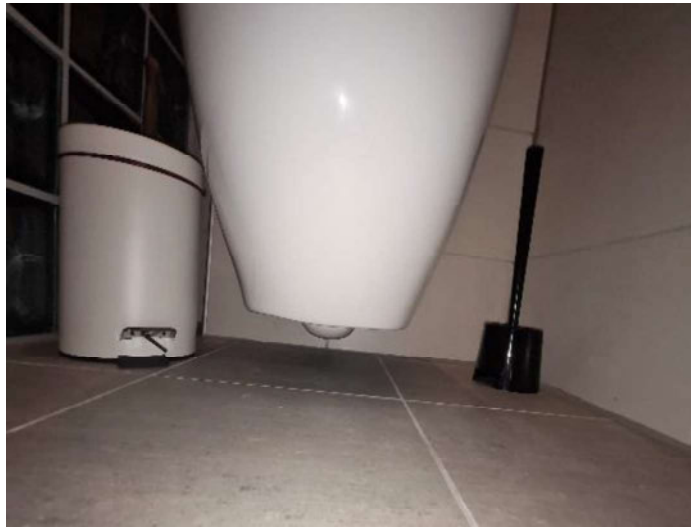
Innbygningstoalett mangler lekkasjedrenshull
