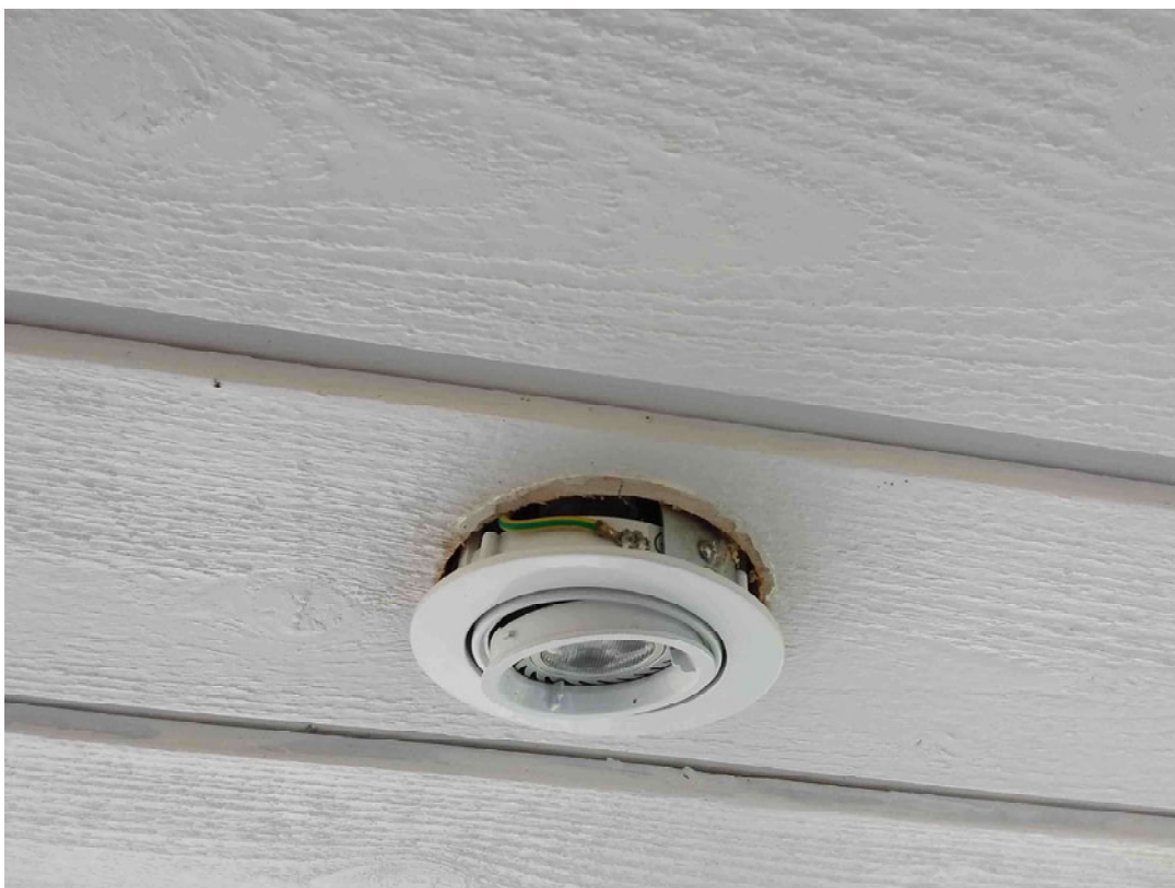
Skjema: "SpareBank1 Brannforebyggende elkontroll" Spørsmål: Merknad Beskrivelse: Downlights utvendig 1etg, Filnavn: IMG_20200528_095316.jpg
