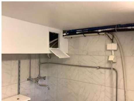
K-rør ikke festet, PN åpent forlagt.
