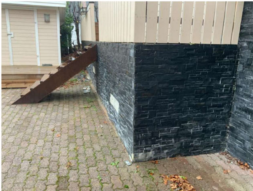
Fasadefliser mur løsner
