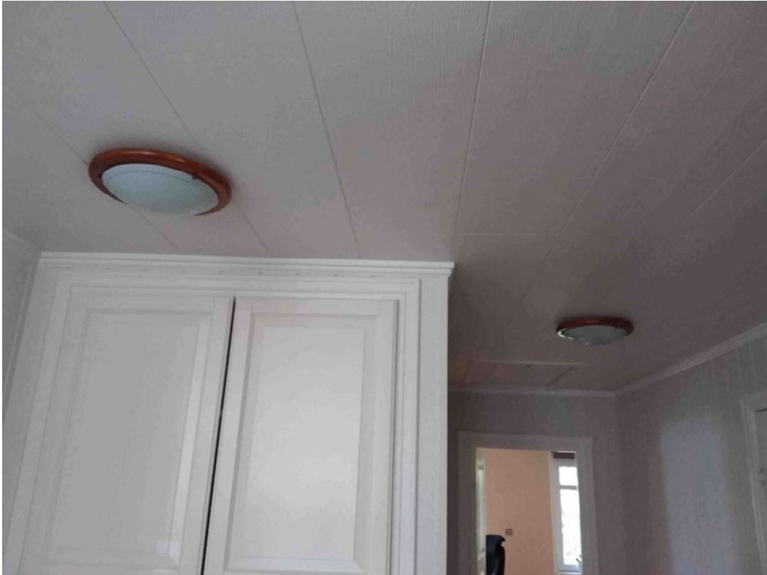
Skjema: "SpareBank1 Brannforebyggende elkontroll" Spørsmål: Kabler, ledninger, fastmontert utstyr og forbrukerutstyr Beskrivelse: Tak i gang 1 etg., Filnavn: IMG_20200528_130818.jpg
