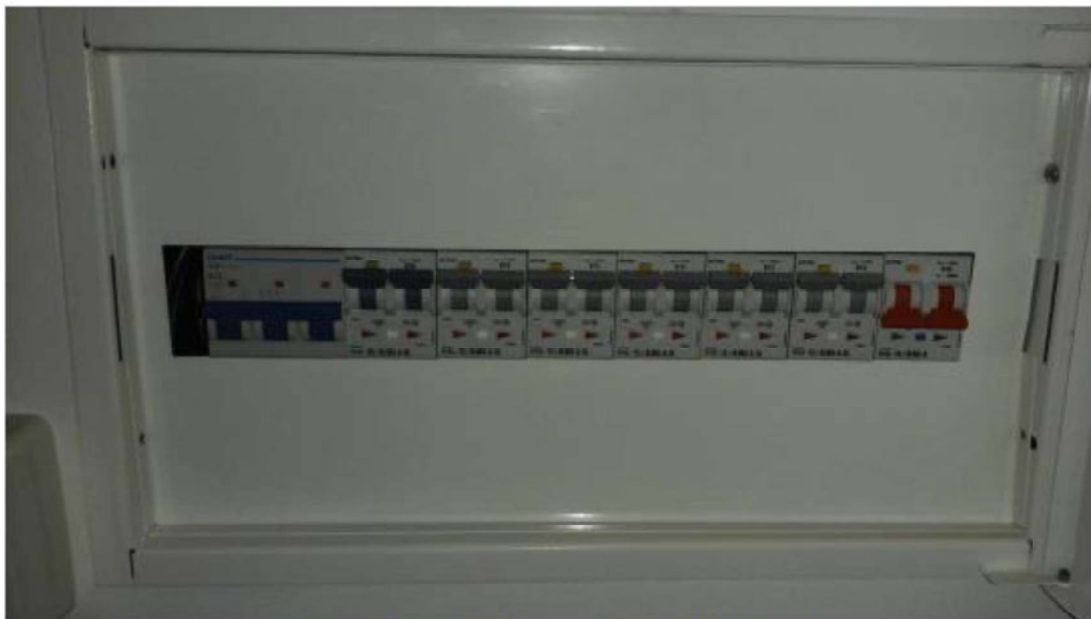
Skjema: "SpareBank 1 Brannforebyggende elkontroll: Leilighet" Spørsmål: Sikringslokk, bunnskruer og renhold Beskrivelse: Manglende merking og avdekning for å opprettholde ip 2x, Filnavn: IMG_20200604_084657.jpg
