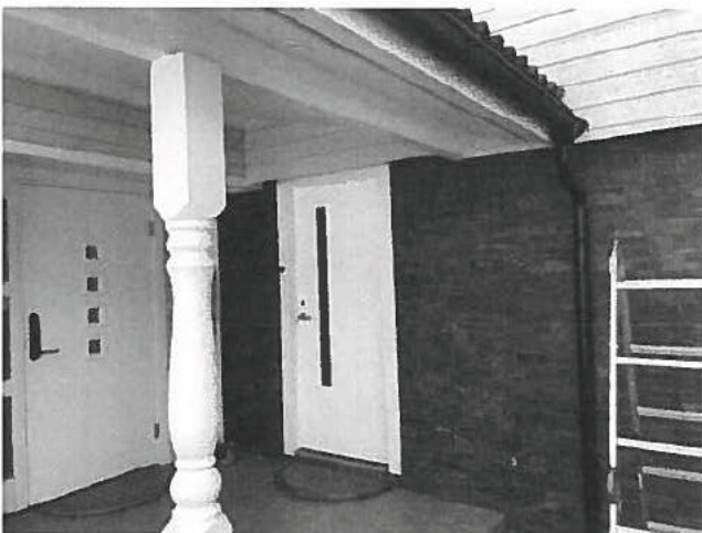
Bærebjelke for takoverbygg har ikke tilstrekkelig innfesting.
