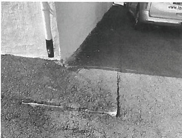
Støpt plate for garasje stikker ca 50cm lenger ut en yttervegg
