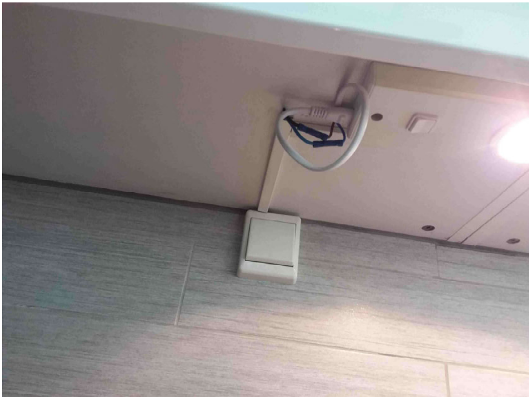
Skjema: "SpareBank1 Brannforebyggende elkontroll" Spørsmål: Merknad Beskrivelse: Lys u/overskap, Filnavn: IMG_20200528_101527.jpg
