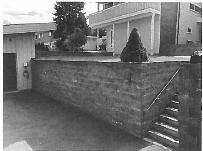
Støttemur mangler sikring for fallskader
