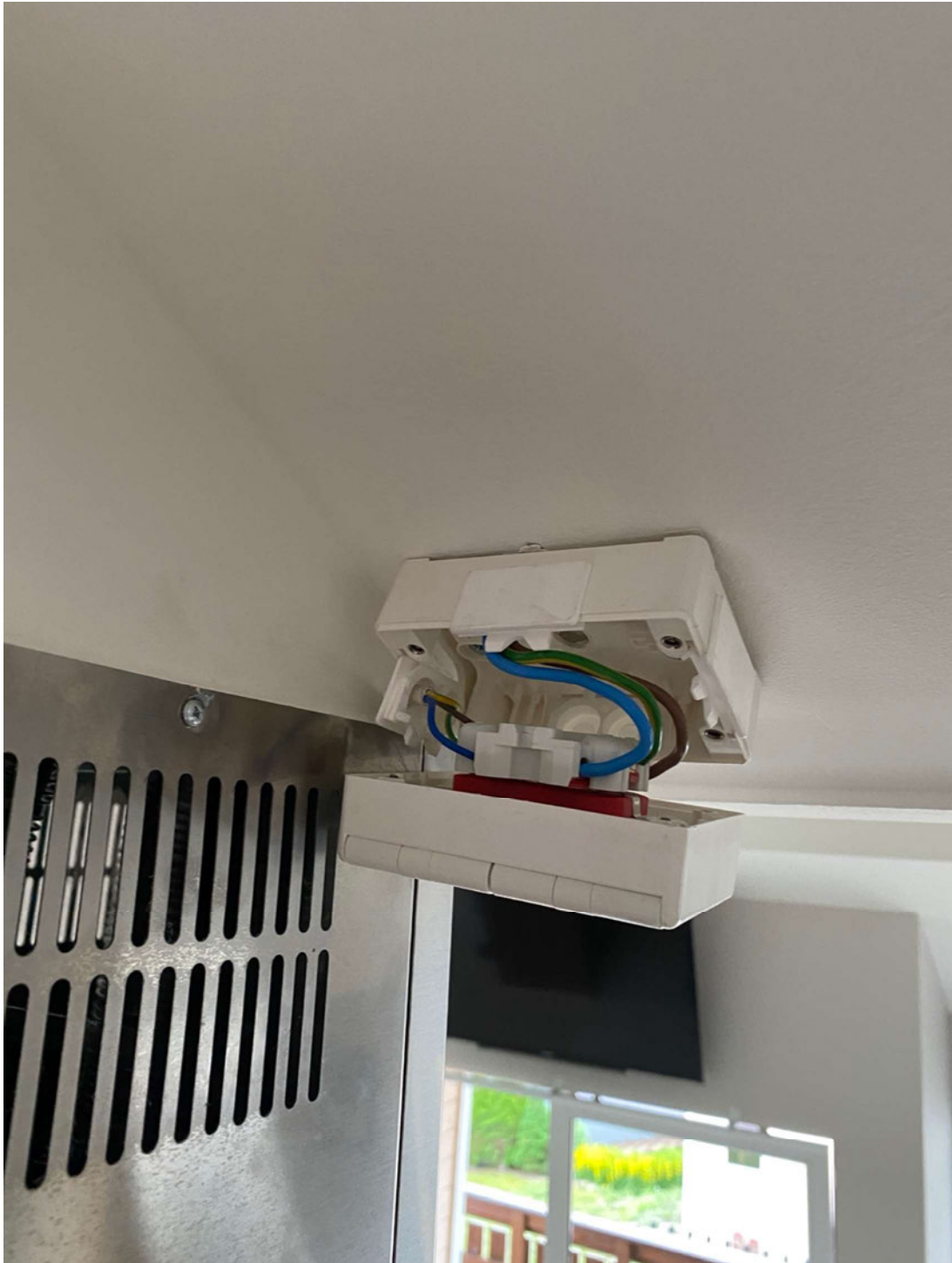
Bilde 23. Skjøting av bevegelig leder til fast installasjon. Ikke fagmessig utførelse jfr kvalifikasjonskrav og FEL §§1 og 38.
