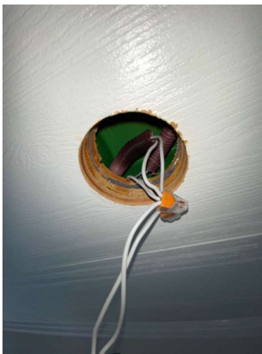
Bilde 34. Tydelig varmgang på rør. Ikke fagmessig utførelse, flaks at det ikke er noe som har tatt fyr tidligere. Avvik på alt av forsvarlig sikkerhetskrav i lov og forskrifter.
