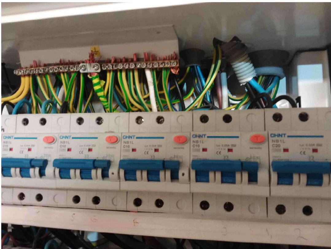
Skjema: "SpareBank1 Brannforebyggende elkontroll" Spørsmål: Merknad Beskrivelse: Kabelinnganger, Filnavn: IMG_20200528_085545.jpg
