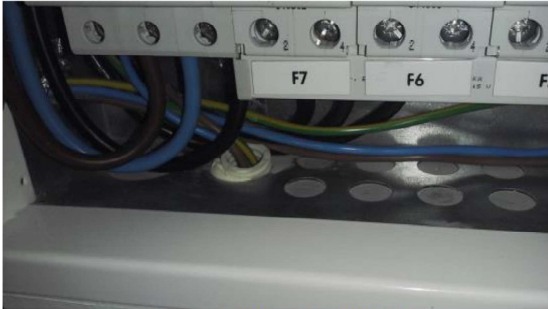
Skjema: "SpareBank 1 Brannforebyggende elkontroll: Leilighet" Spørsmål: Kabelinnføring Beskrivelse: kabel innføring, Filnavn: IMG_20200604_084237.jpg
