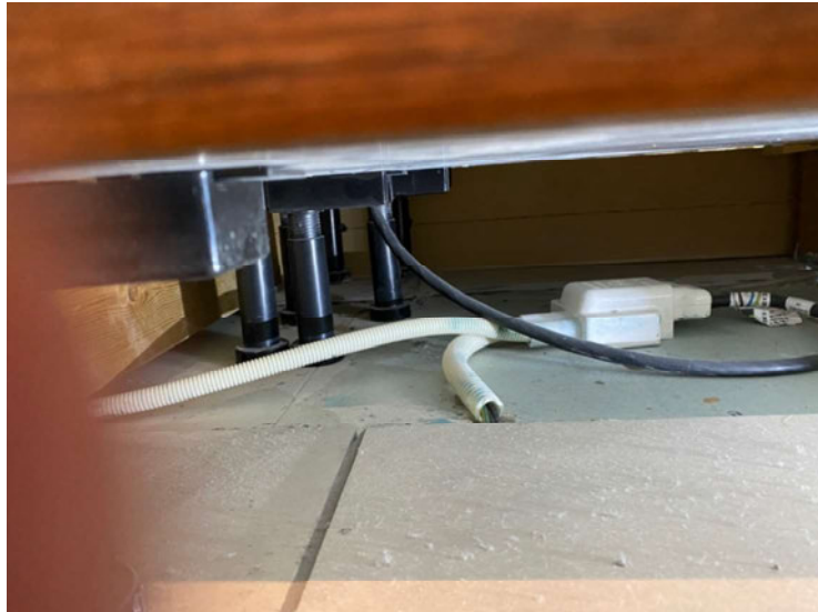
Bilde 24. Ikke fagmessig installasjon under kjøkkenøy. Ledninger utsatt, rør utsatt, installasjon oversikret, dvs tilkoblet utstyr har for store forankoblede sikringer slik at stikkontakt og ledere kan bli overbelastet ut over det de er godkjent for. Brannfarlig. Avvik i forhold til alt av regelverk om forsvarlighet og egnethet. Ikke fagmessig installasjon.
