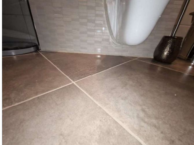
Innbygningstoalett mangler lekkasjedrenshull
