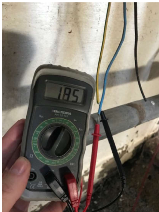
Bilde 41. Tatt av boligeier. Som majoriteten av øvrig installasjon er ikke dette i samsvar med regelverk.
