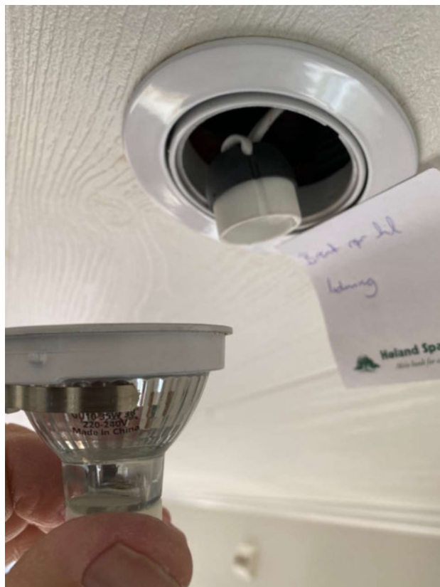
Bilde 32. Orientering om at det er mange brente rør i kassene over lampene. Tyder på annen varmekilde tidligere, mens det skulle ha vært en dokumentasjon som sa noe om forsvarlig bruk av dette anlegget i hht NEK 400 2010,514,5.101. og FEL §10, 22,34,35.
