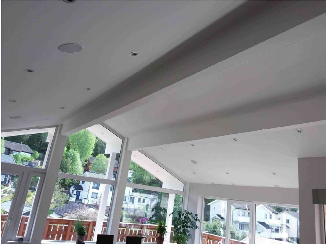
Skjema: "SpareBank1 Brannforebyggende elkontroll" Spørsmål: Merknad Beskrivelse: Downlights kjøkken, Filnavn: IMG_20200528_101353.jpg
