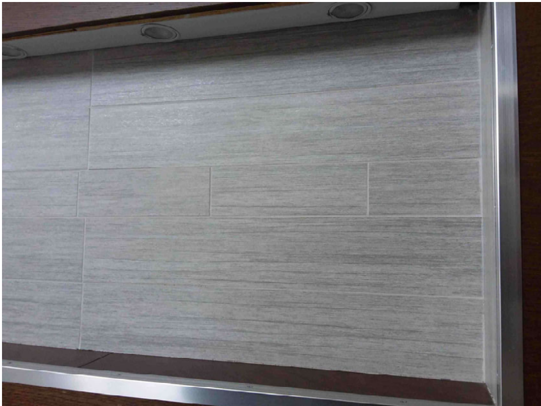
Skjema: "SpareBank1 Brannforebyggende elkontroll" Spørsmål: Merknad Beskrivelse: Lamper i nisje, Filnavn: IMG_20200528_100906.jpg
