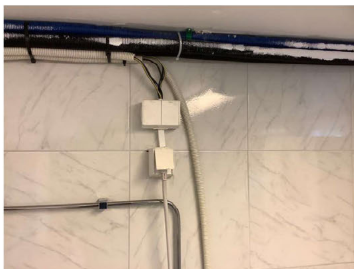
Støpsel til bereder antar høy temperatur, helt ulovlig installasjon, oversikret, brannfarlig. Se også bilder i Vestby elektro service sine rapporter. Bilde tatt av kjøpersiden
