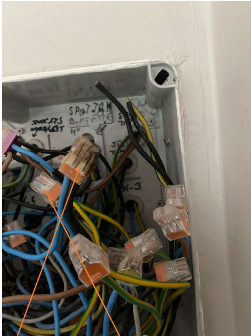
Bilde 18. Svidd kobling og eksempel dårlig kobling. Kobberet skal være synlig over sperrefjærer men er ikke det flere steder, og varmgang er naturlig konsekvens, noe som medfører økt brannrisiko.
