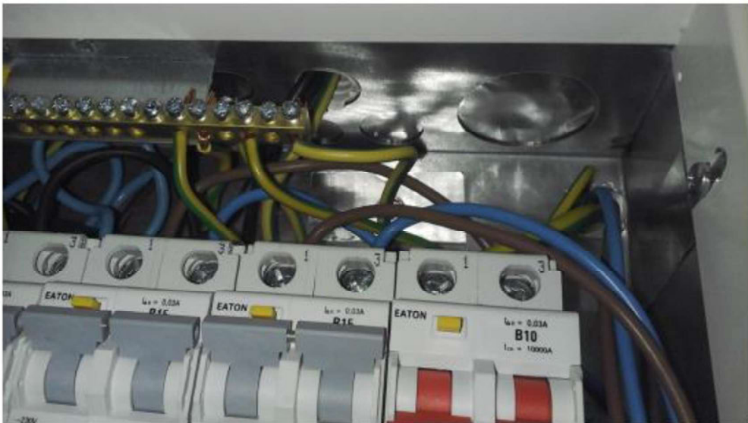
Skjema: "SpareBank1 Brannforebyggende elkontroll: Leilighet" Spørsmål: Kabelinnføring Beskrivelse: Manglende nippler, Filnavn: IMG_20200604_084200.jpg
