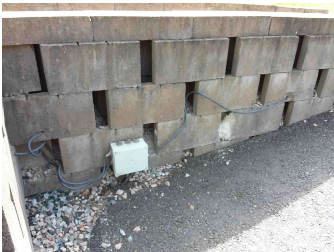
Skjema: "SpareBank1 Brannforebyggende elkontroll" Spørsmål: Merknad Beskrivelse: Lamper på mur, Filnavn: IMG_20200528_125514.jpg
