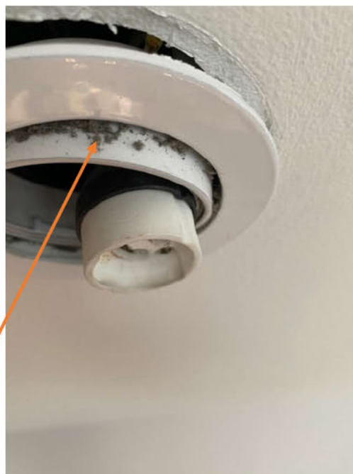
Bilde 20. Mye støv / møkk i gjennomføringer i lampe tyder på utetthet. Tatt i betraktning bolig bygget i 2010, er det stor usikkerhet til om den tilfredsstillende tetthetskrav i hht TEK 10, men bør utredes av andre. Samme avviksspesifikasjon som på bilde 19.
