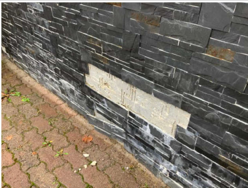
Fasadefliser mur løsner
