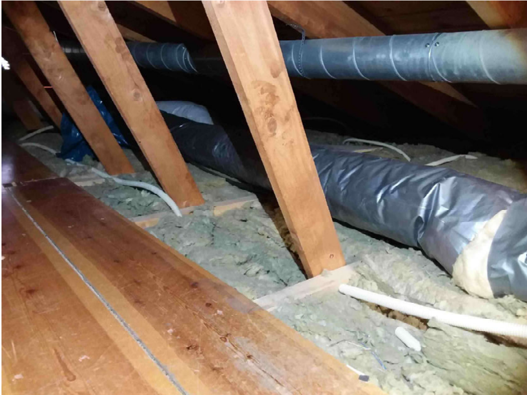
Skjema: "SpareBank1 Brannforebyggende elkontroll" Spørsmål: Merknad Beskrivelse: K-rør loftet., Filnavn: IMG_20200528_104236.jpg
