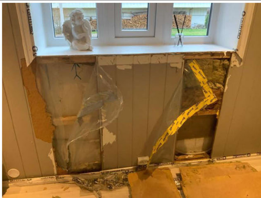
Under vindu kjellerstue. Fuktskadet konstruksjoner.
