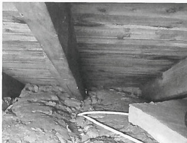
Raft på loft er tettet med isolasjon
