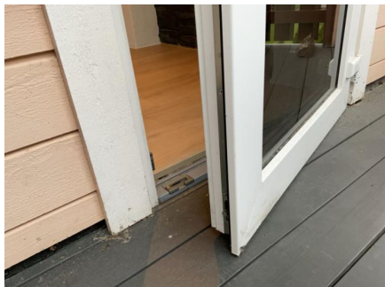
Lite høyde fra gulv og til dørterskel/gulv.
