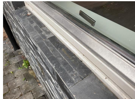
Manglende beslag under vindu.
