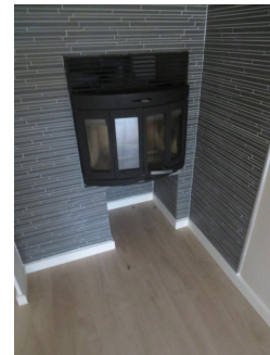
Ildsted i under-etg. Manglende gnistplate på gulv.
