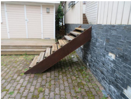
Manglende rekkverk på trapp.
