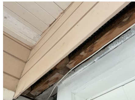
Fukt registrert i utforing/bindingsverk.
