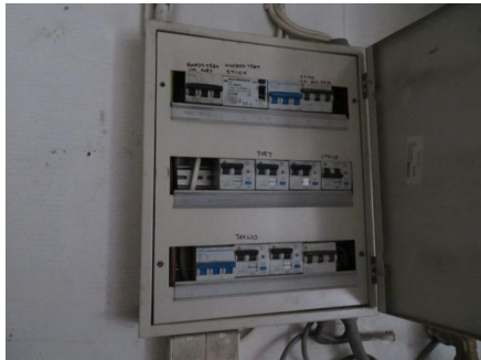
Sikringskap i garasjen.
