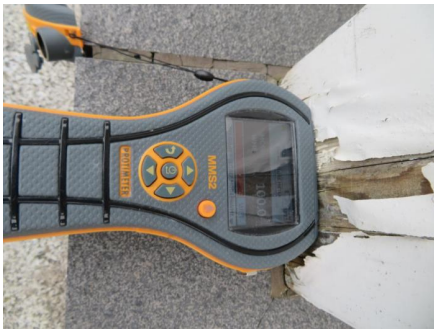
Fukt og råte registrert i bærestolper.
