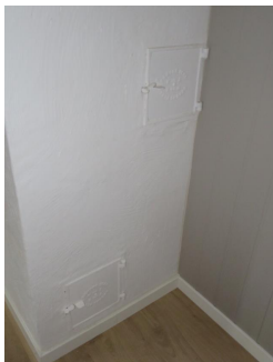
Feieluker med lite avstand til brennbart material.
