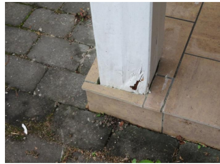
Bærestolpe ført ned i støp/fliser. Råte registrert.
