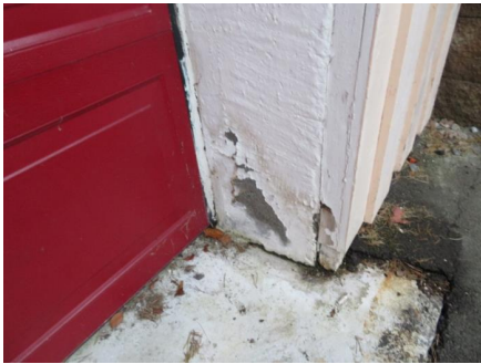
Fuktutslag på mur. Treverk mot grunnen.
