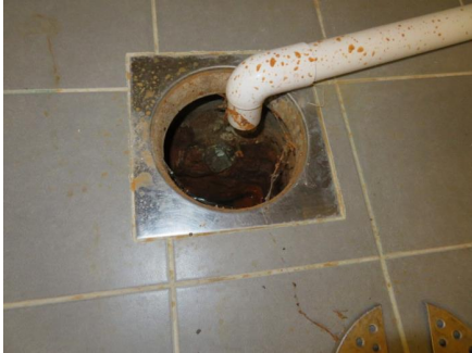
Gammelt sluk i teknisk rom.
