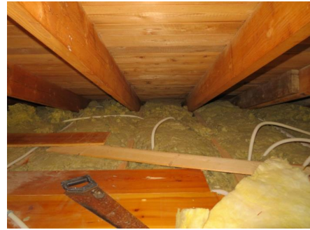
Isolasjon lagt tett, uten lufting.
