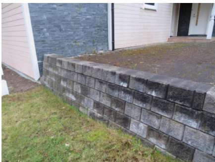
Manglende fallsikring på mur.
