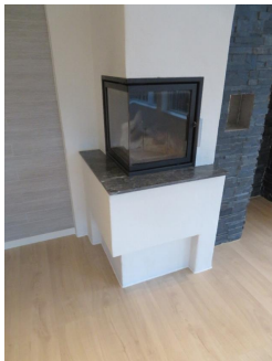
Ildsted i kjøkken. Manglende gnistplate på gulv.
