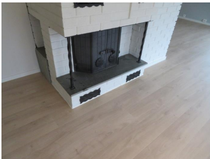
Ildsted i stuen. Manglende gnistplate på gulv.
