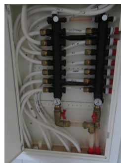
Fordelerskap i soverom i under-etg.
