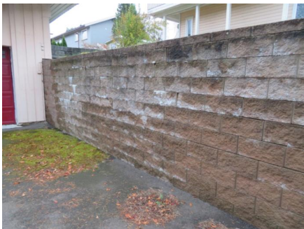
Saltutslag på forstøtningsmur.
