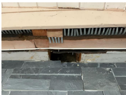
Hull opp i yttervegg.
