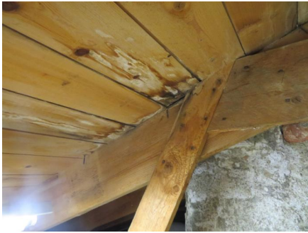
Fuktmerker på loft. Dette er av eldre dato.
