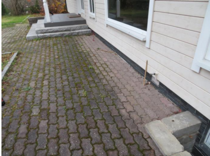
Fall på terreng inn mot bygget.
