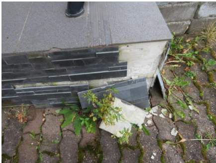
Div. skader på trapp på inngang.
