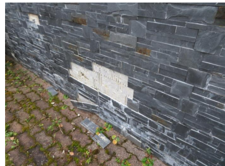
Løse fliser på murer.
