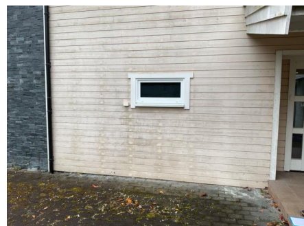
Ytterkledning har behov for overflatebehandling. Panel helt ned til belegningsstein. Spiker dekket med en type maling/fugemasse.
