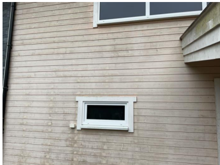
Manglende beslag over vindu.
