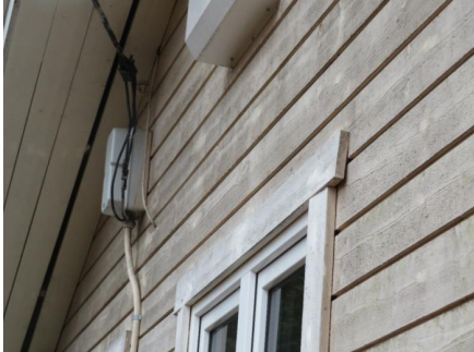
Manglende beslag over vinduer.
