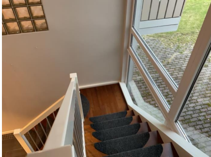
Manglende håndløper på vegg.
