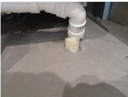
Avløp fra badekar. Uheldig løsning.
