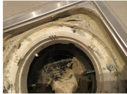
Feil utførelse på slukløsning.
