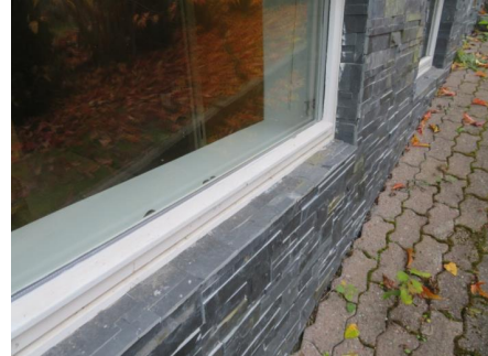
Manglende beslag under vinduer.
