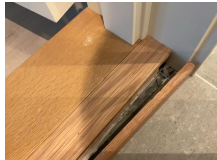
Mangelfull membranløsning ved dør.
