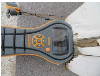
Fukt og råte registrert i bærestolper.
