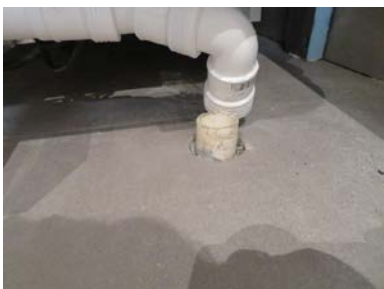
Avløp fra badekar. Uheldig løsning.
