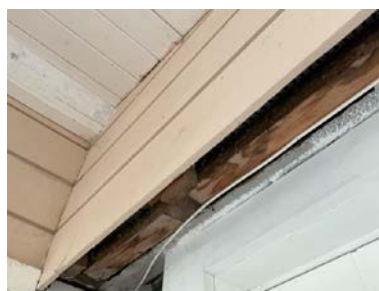
Fukt registrert i utforing/bindingsverk.
