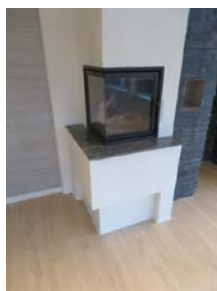
Ildsted i kjøkken. Manglende gnistplate på gulv.
