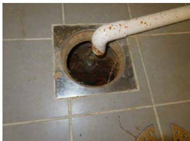
Gammelt sluk i teknisk rom.
