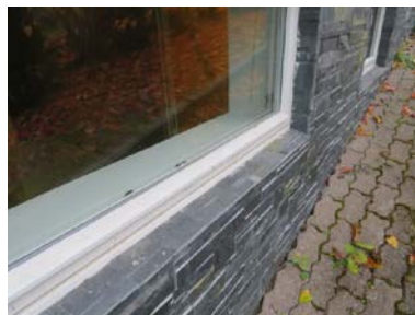
Manglende beslag under vinduer.
