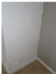
Feieluker med lite avstand til brennbart material.
