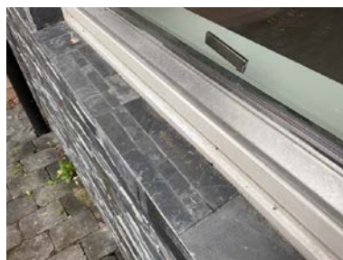
Manglende beslag under vindu.
