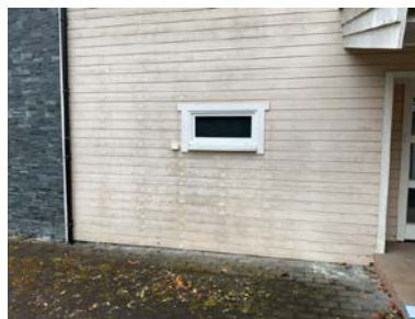
Ytterkledning har behov for overflatebehandling. Panel helt ned til belegningsstein. Spiker dekket med en type maling/fugemasse.
