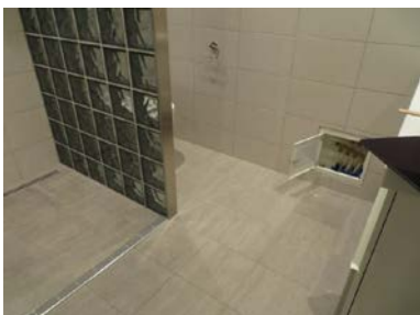
Flis-list på gulv inn mot sluk.
