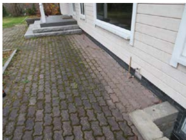
Fall på terreng inn mot bygget.
