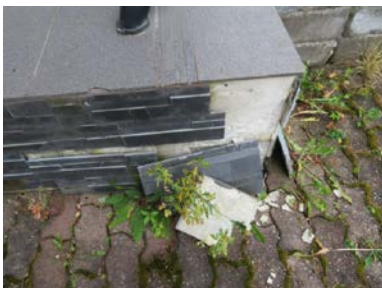
Div. skader på trapp på inngang.
