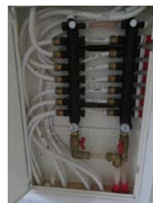
Fordelerskap i soverom i under-etg.
