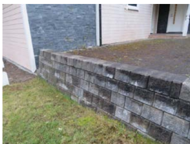
Manglende fallsikring på mur.
