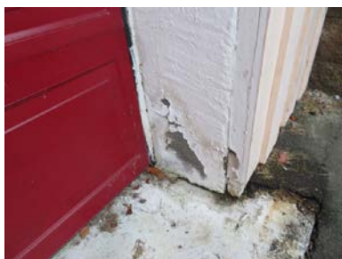
Fuktutslag på mur. Treverk mot grunnen.
