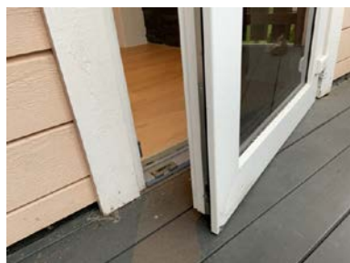
Lite høyde fra gulv og til dørterskel/gulv.
