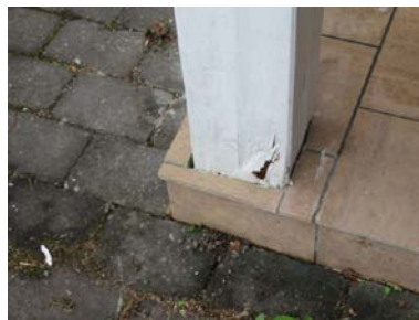
Bærestolpe ført ned i støp/fliser. Råte registrert.
