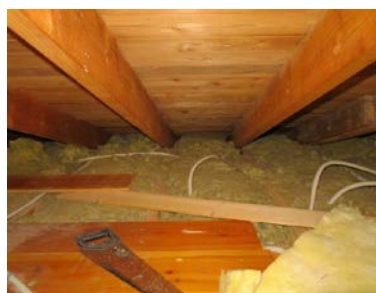
Isolasjon lagt tett, uten lufting.
