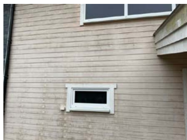
Manglende beslag over vindu.
