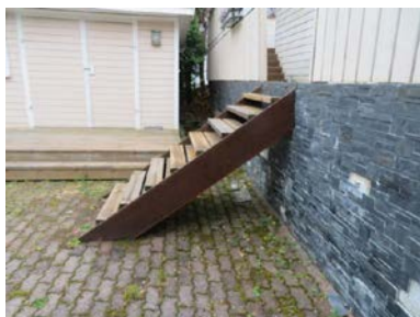
Manglende rekkverk på trapp.
