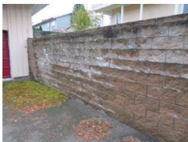
Saltutslag på forstøtningsmur.
