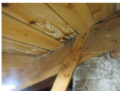
Fuktmerker på loft. Dette er av eldre dato.
