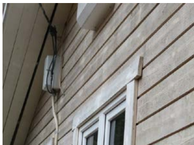
Manglende beslag over vinduer.
