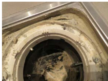
Feil utførelse på slukløsning.
