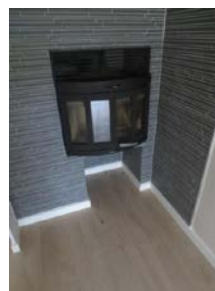
Ildsted i under-etg. Manglende gnistplate på gulv.
