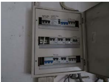
Sikringskap i garasjen.
