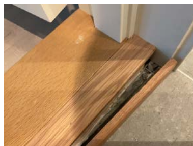
Mangelfull membranløsning ved dør.
