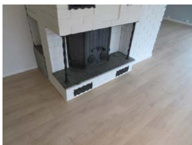
Ildsted i stuen. Manglende gnistplate på gulv.
