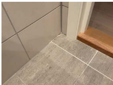
Manglende fugemasse ved dør.
