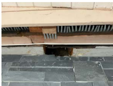
Hull opp i yttervegg.
