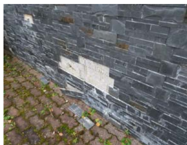
Løse fliser på murer.
