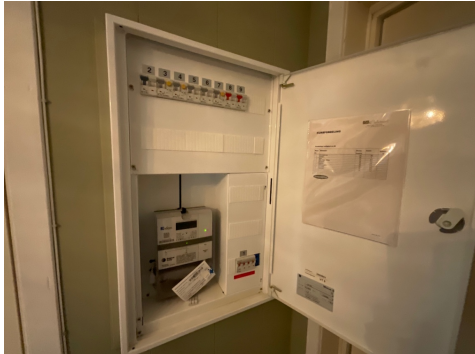
Sikringsskap i entree
