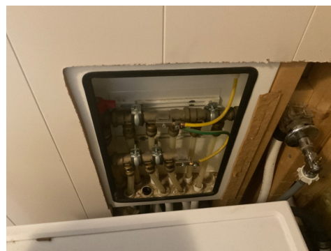
Rør i rør skap i boden
