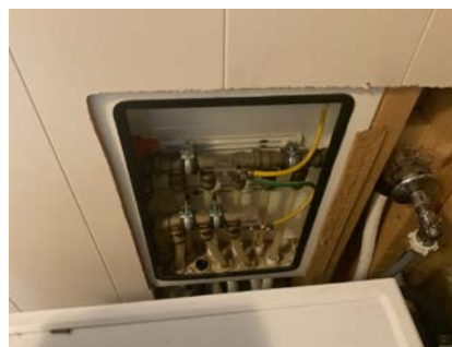
Rør i rør skap i boden
