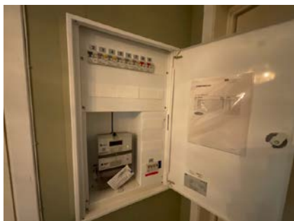
Sikringsskap i entree
