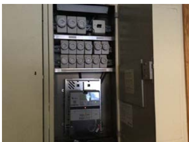
Sikringskap plassert i felles oppgang.
