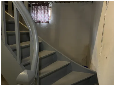
Mangler rekkverk på en side.
