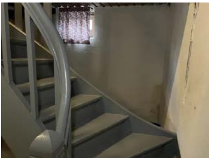
Mangler rekkverk på en side.
