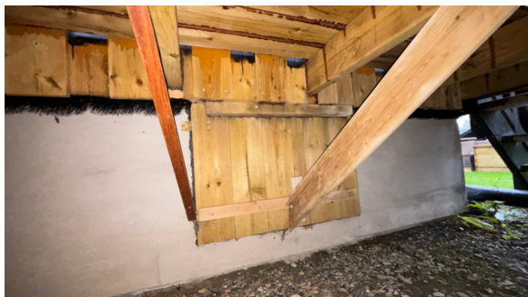
Inngangen til krypkjeller er tett/skrudd fast
