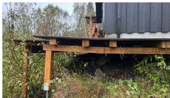
Skjevheter i konstruksjon
