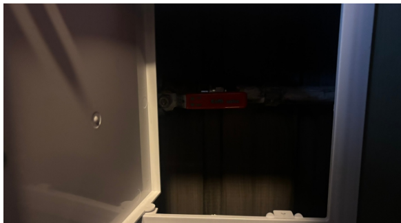
Hovedstoppekranen er plassert i gangen
