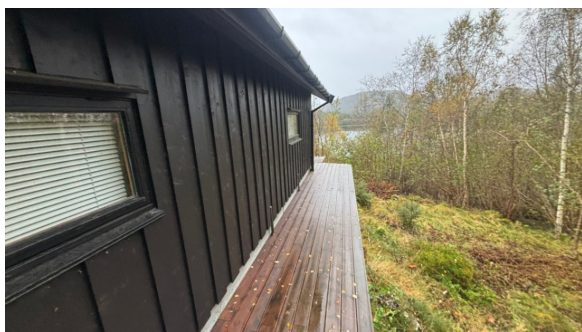
Verandaen er uten rekkverk
