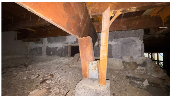
Avvik i bærekonstruksjon av veranda
