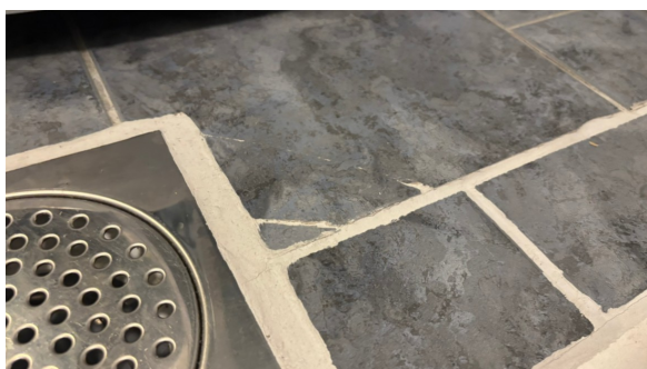
Sprukket flis ved sluket
