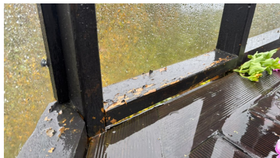
Stedvis værslitte overflater
