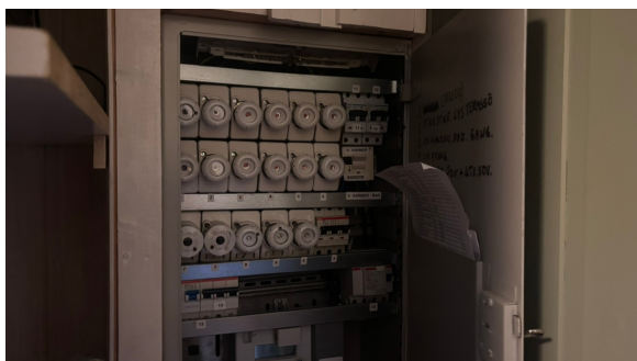
Fordelerskapet er plassert i gangen
