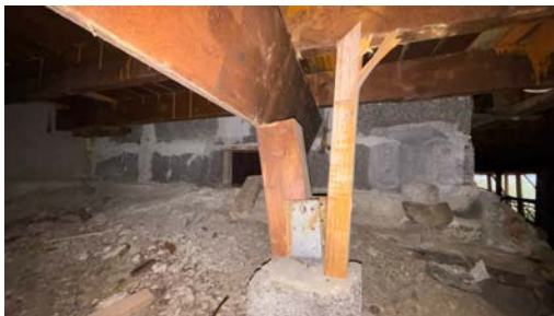
Avvik i bærekonstruksjon av veranda
