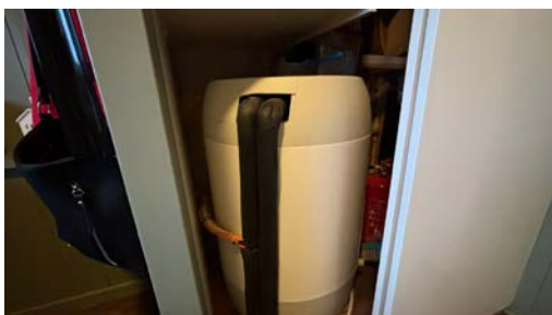
Berederen er plassert i skapet i gangen
