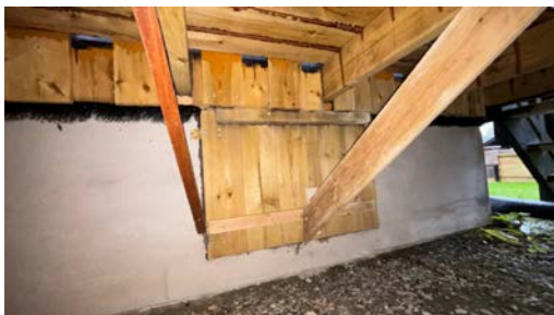
Inngangen til krypkjeller er tettet/skrudd fast
