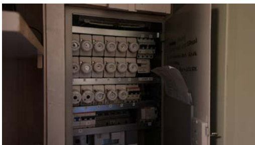
Fordelerskapet er plassert i gangen
