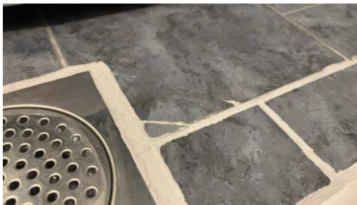
Sprukket flis ved sluket
