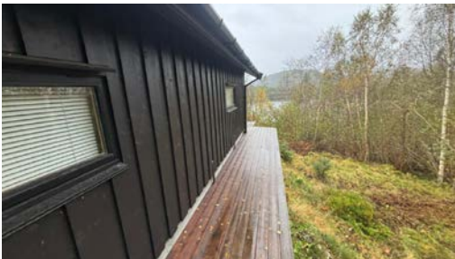
Verandaen er uten rekkverk
