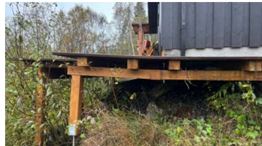
Skjevheter i konstruksjon
