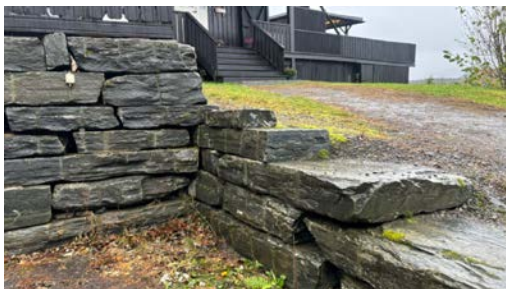
Forstøtningsmur i naturstein uten rekkverk
