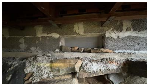
Ventil fra krypkjeller
