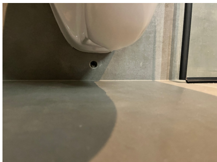
Drensåpning for innbygget toalettsisterne.
