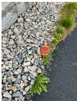
Utvendig spylepunkt for avløpsanlegget.
